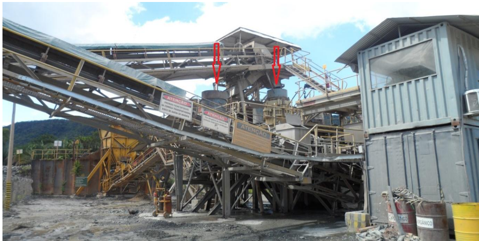
Figura 02: Britadores Cônicos da Unidade de Beneficiamento da RML.
