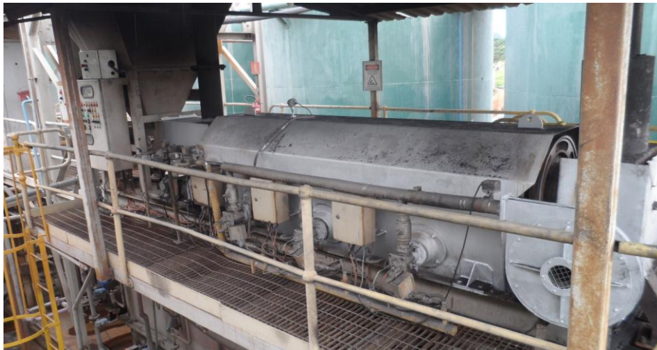
Figura 11: Regenerador de Carvão da Unidade de Beneficiamento da RML.
