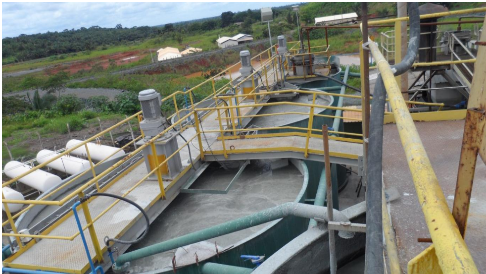
Figura 09: Tanques de Adsorção da Unidade de Beneficiamento da RML.
