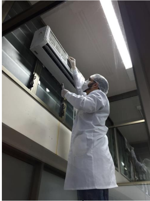
Figura 1- Coleta realizada no filtro de ar condicionado da UTI Pediátrica do HGPP.
