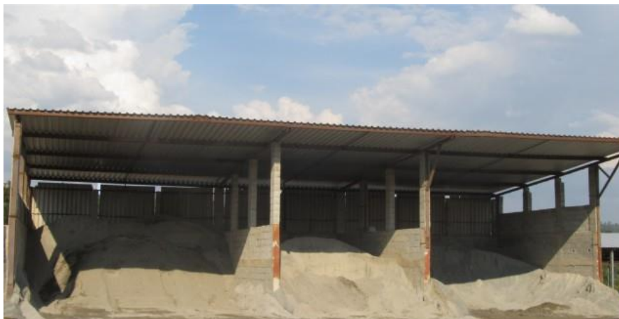
Figura 42: Estocagem de agregados em baias cobertas.
