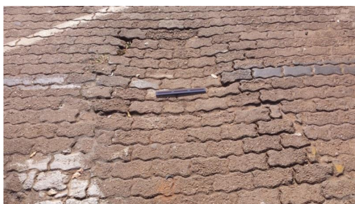
Figura 22: Manifestação patológica por recalque ou afundamento plástico.
