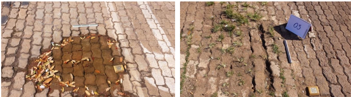
Figura 26: Manifestação patológica relacionada à areia de assentamento.
