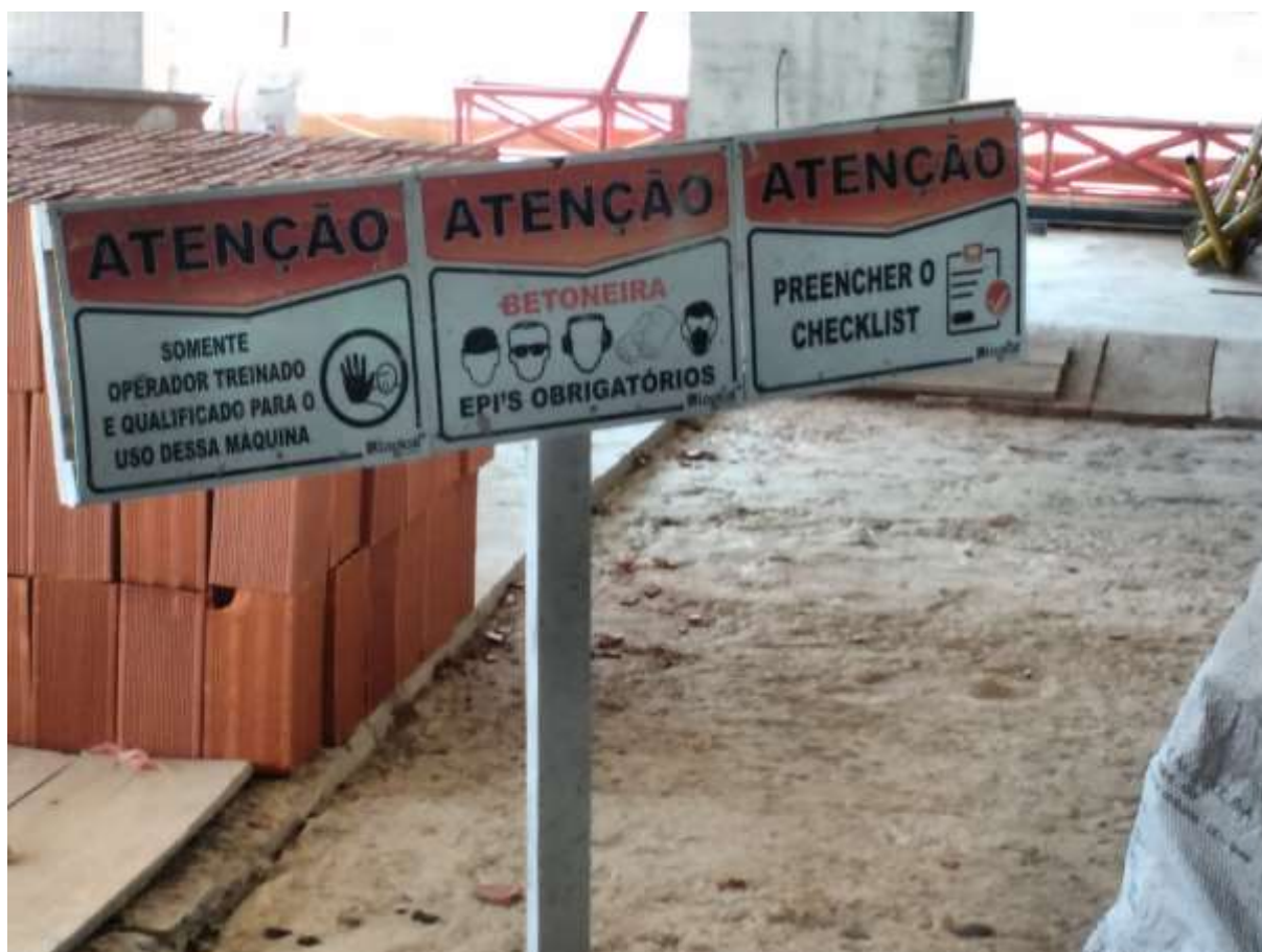
Figura 8: Placas explicativas sobre procedimentos de operação da betoneira
