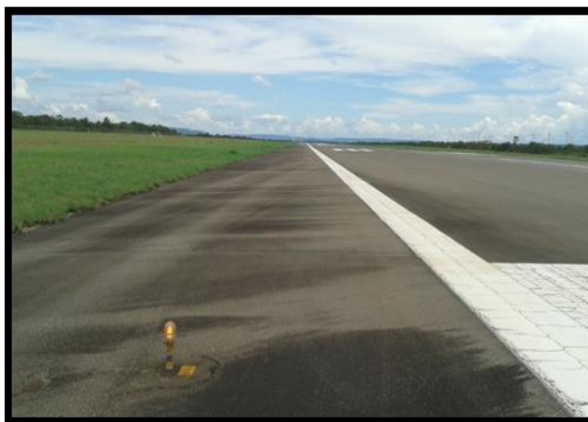
Foto 6 – Auxílios luminoso instalados nos dois lados ao longo da pista de pouso e decolagem.
