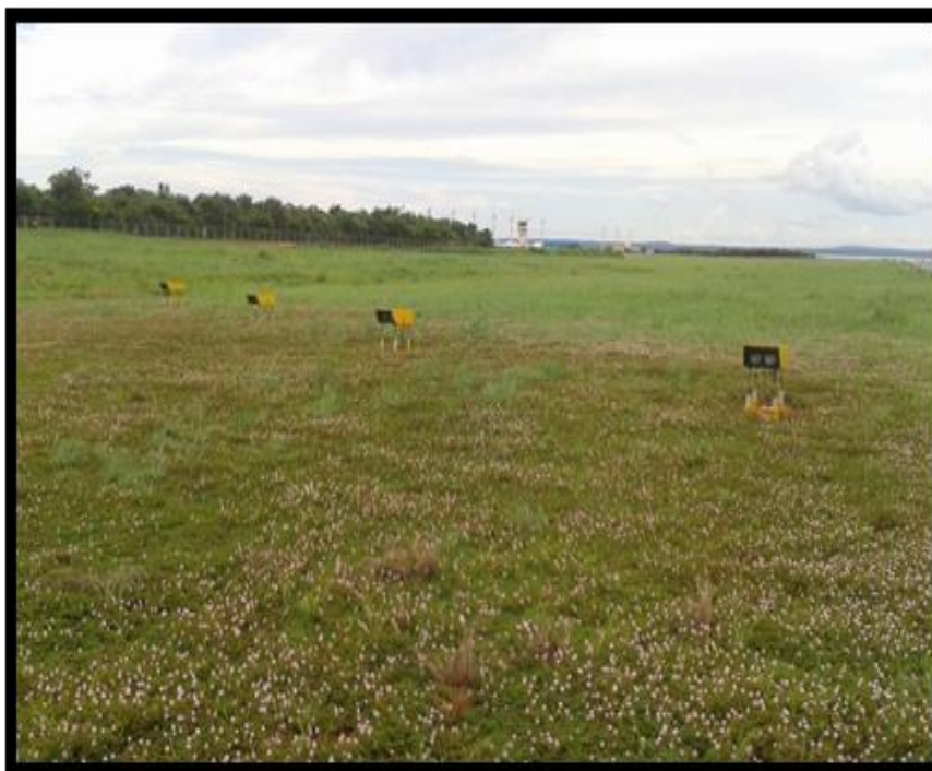
Foto 5 – Equipamentos de rampa ( PAPI ) instalados ao lado das cabeceiras 14 e 32.
