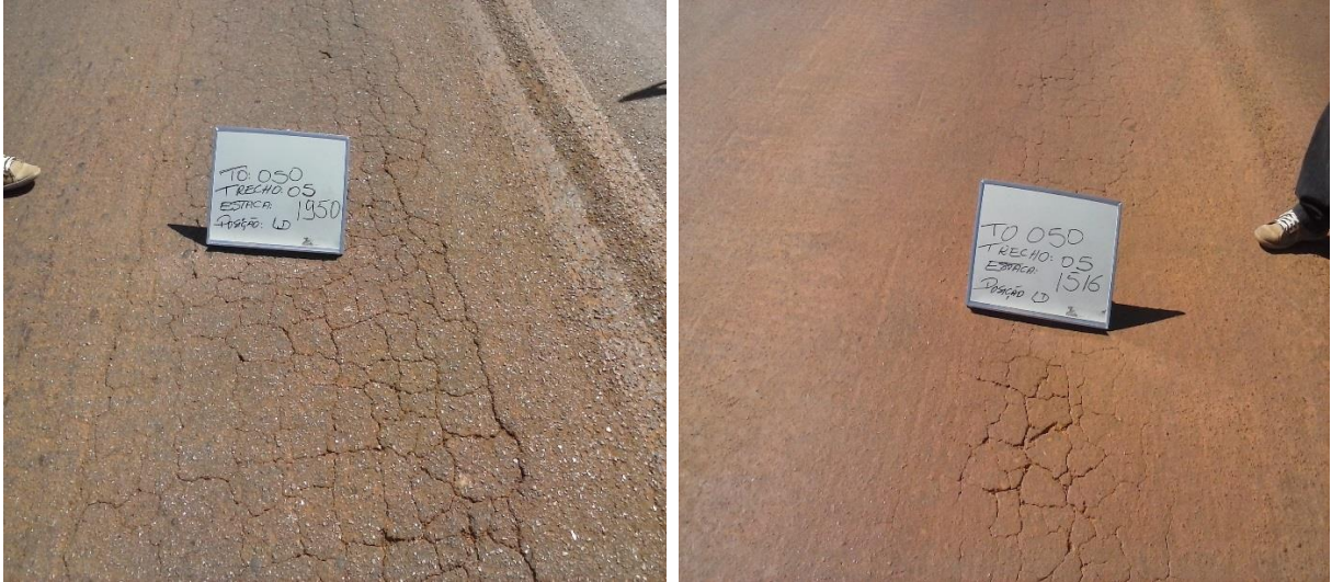
Figura 20 – Trincas tipo “couro de jacaré”
