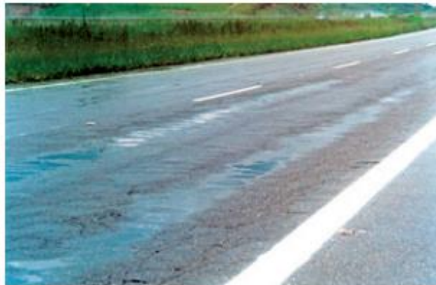
Figura 11 – Afundamento por consolidação em trilha de roda
