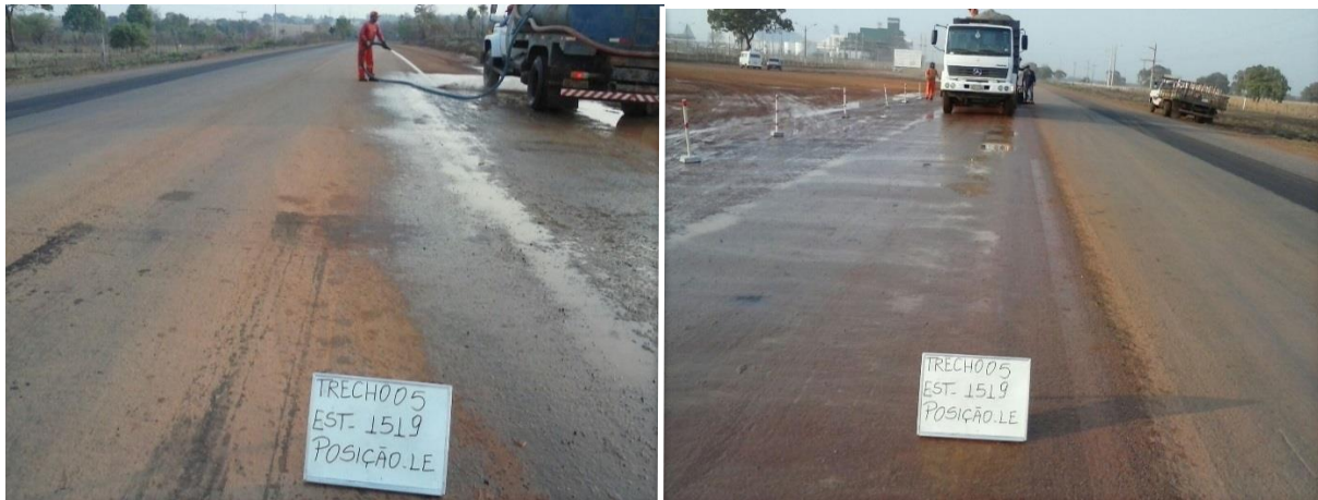
Figura 42 – Desconformidade na execução do MRAF
