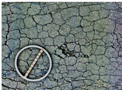
Figura 8 – trinca interligada tipo jacaré
