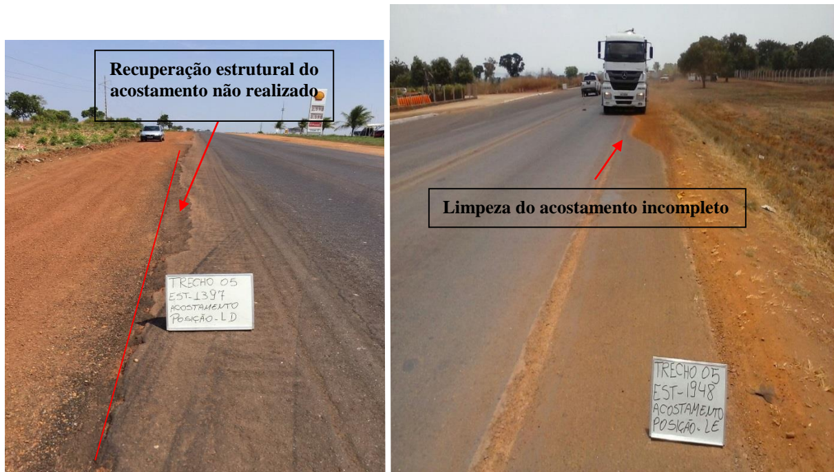
Figura 44 – Falta de reparos nos acostamentos
