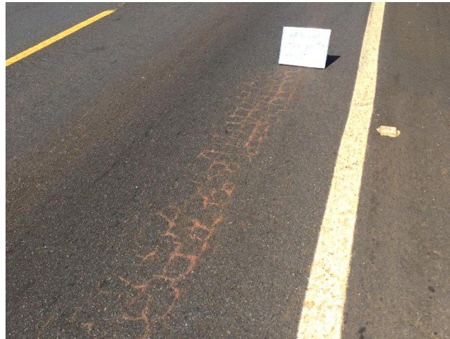
Figura 48 – Trincas “tipo couro de jacaré” sobre o novo revestimento
