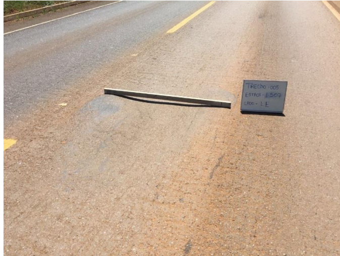
Figura 50 – Afundamento por consolidação em trilha de roda
