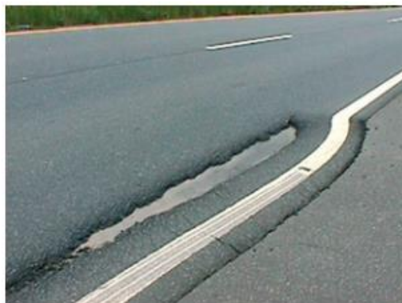
Figura 13 – escorregamento do revestimento
