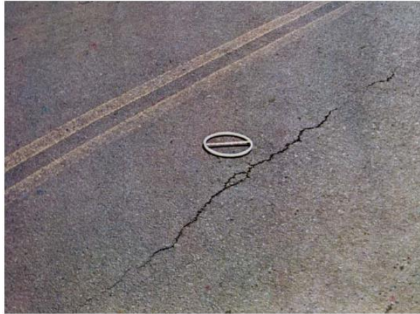
Figura 7 – trinca isolada longitudinal
