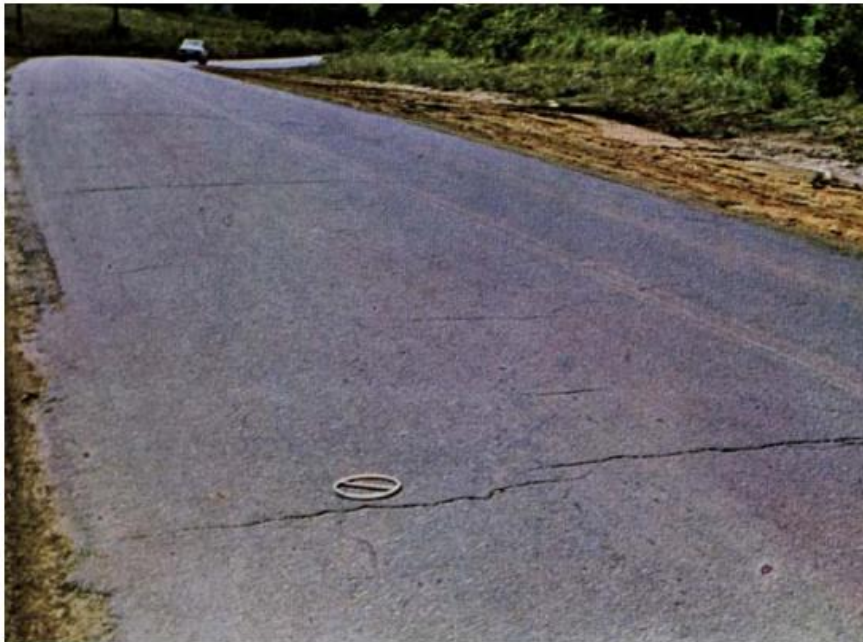
Figura 6 – trinca isolada transversal
