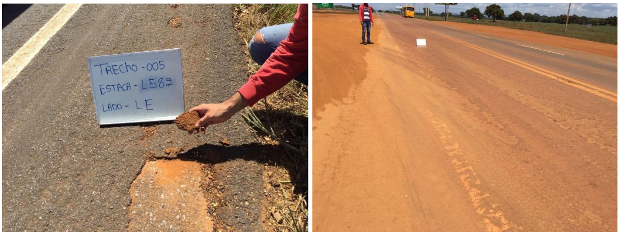
Figura 52 – Falta de ligação com o pavimento antigo
