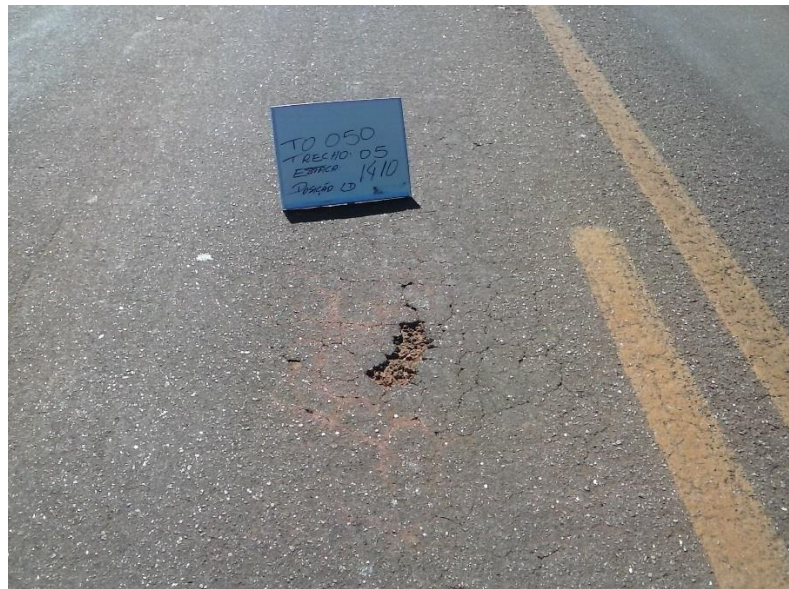
Figura 24 – Estágio final da trinca tipo “couro de jacaré”
