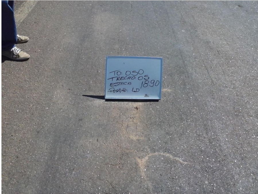
Figura 23 – Trinca com bombeamento de finos
