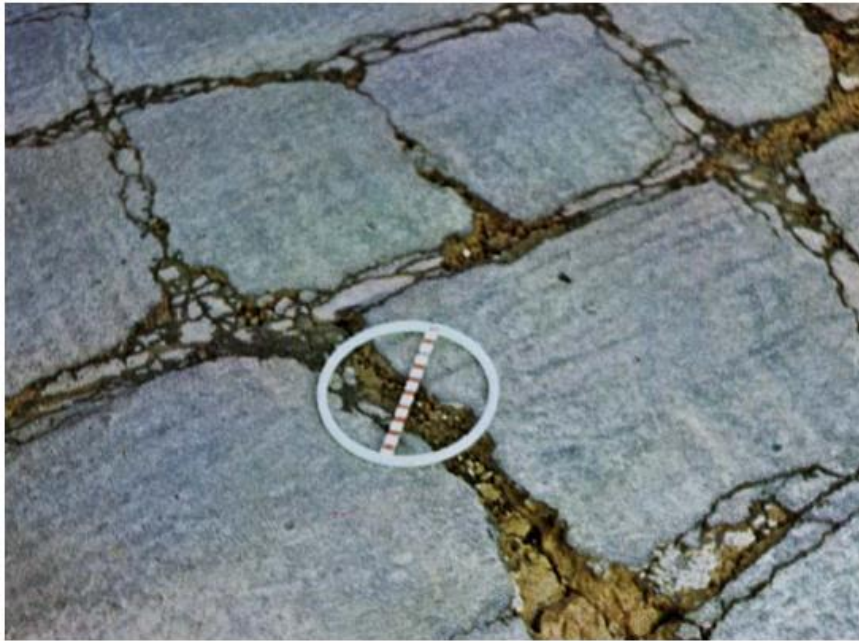
Figura 9 – trinca interligada tipo bloco
