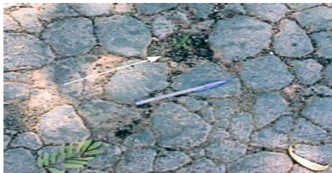
Figura 16 – Trinca couro de jacaré com erosão Fonte: Bernucci et al. (2008).
