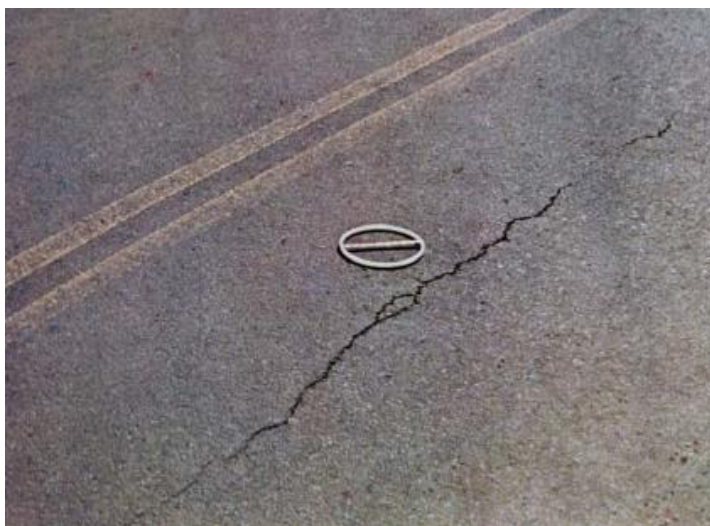
Figura 14 – Trinca isolada longitudinal (RS-155) Fonte: DNIT 005/2003 TER
