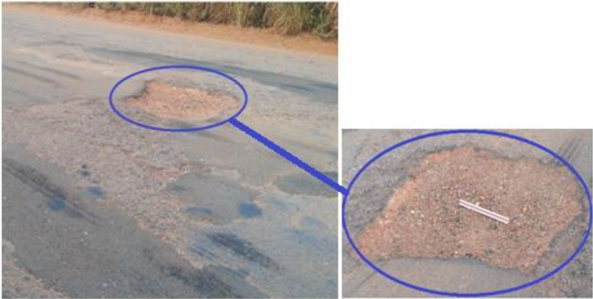
Figura 34: Panela/Buraco - Rodovia TO-070.
