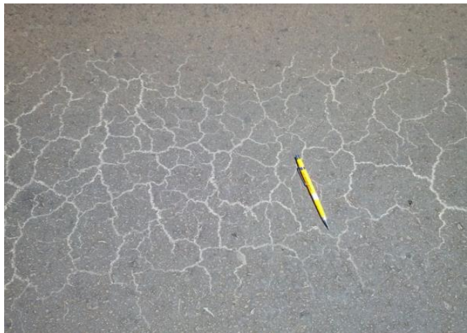
Figura 15 – Trinca couro de jacaré (RS-155) Fonte: Autoria própria (2013).
