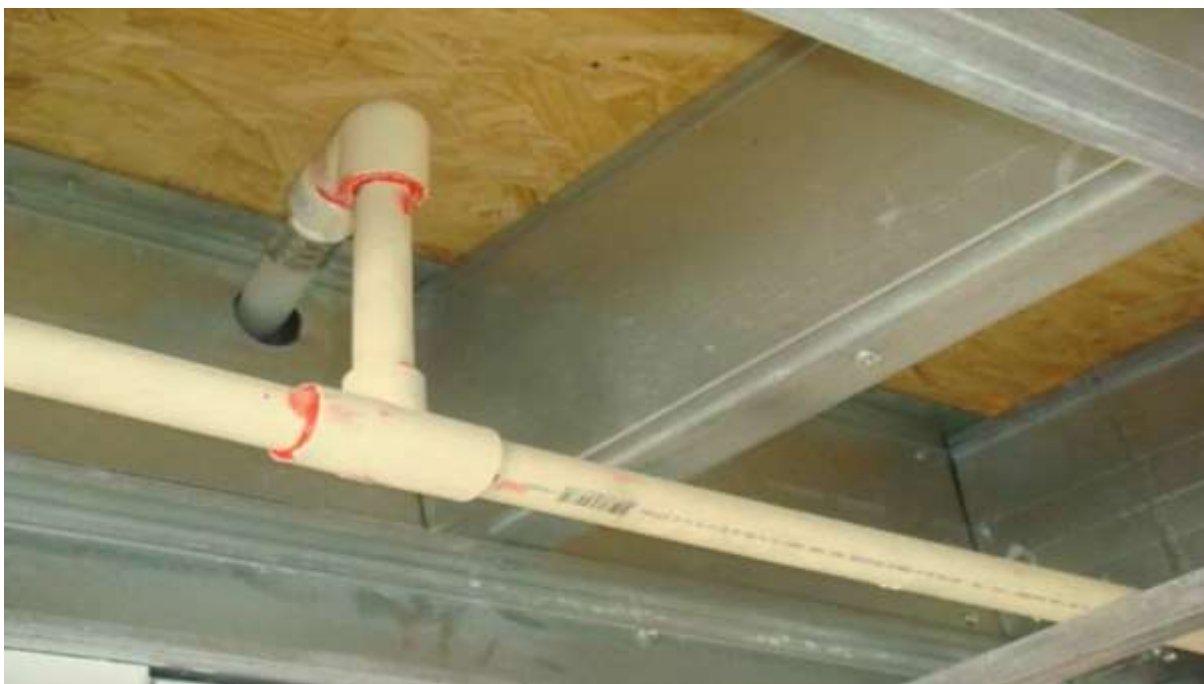
Figura 5: Tubulação passando pelo perfil que compõe uma laje em LSF
