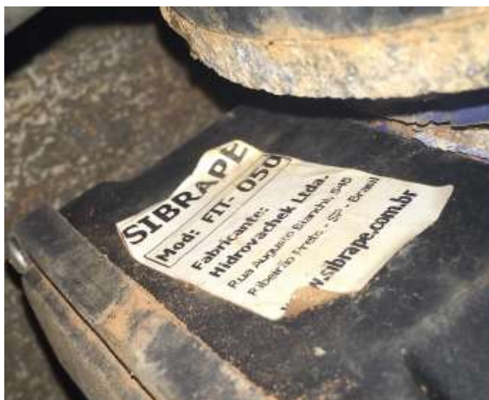
Figura 5: Modelo de bomba utilizada na casa de máquinas da piscina.
