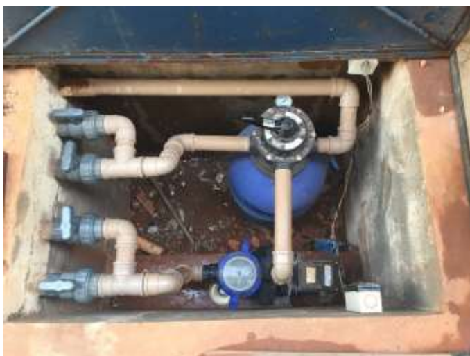
Figura 6: Casa de máquina da piscina.
