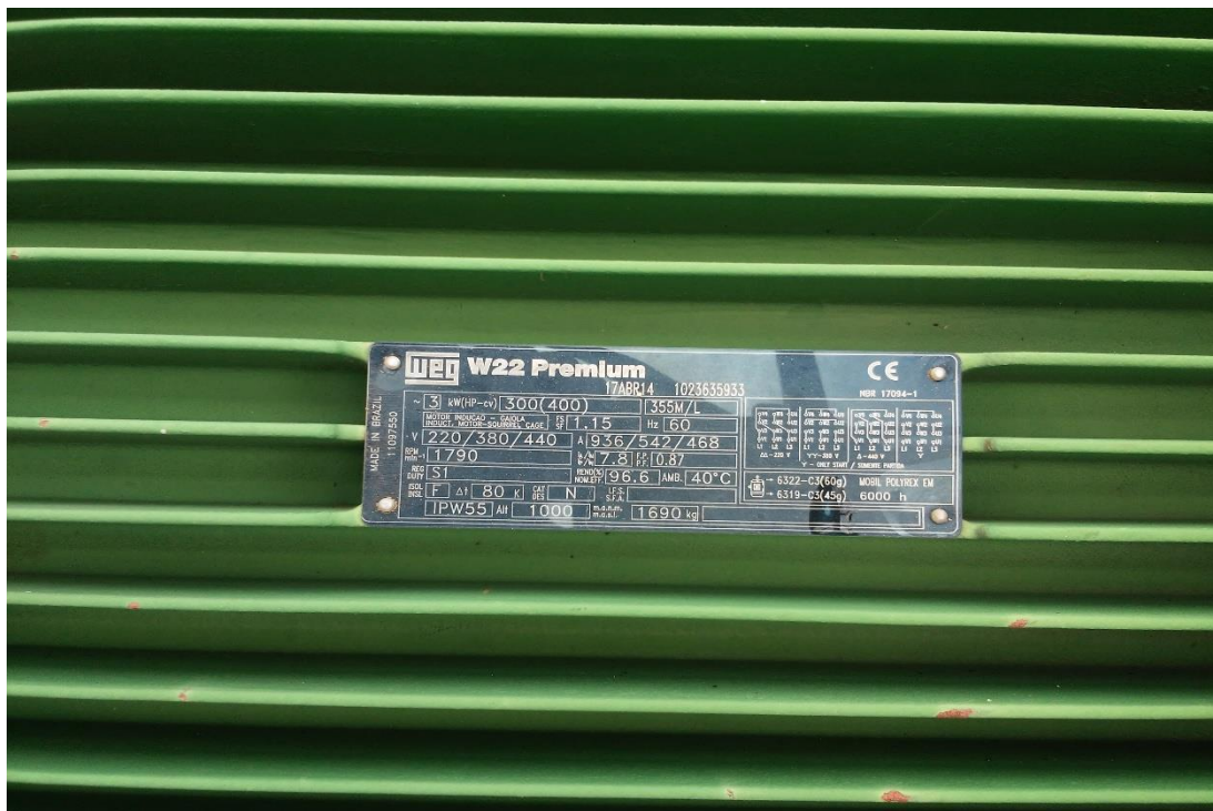
Figura 17: Conjunto Motorbomba atual ETA 006 Fonte: Próprio Autor.
