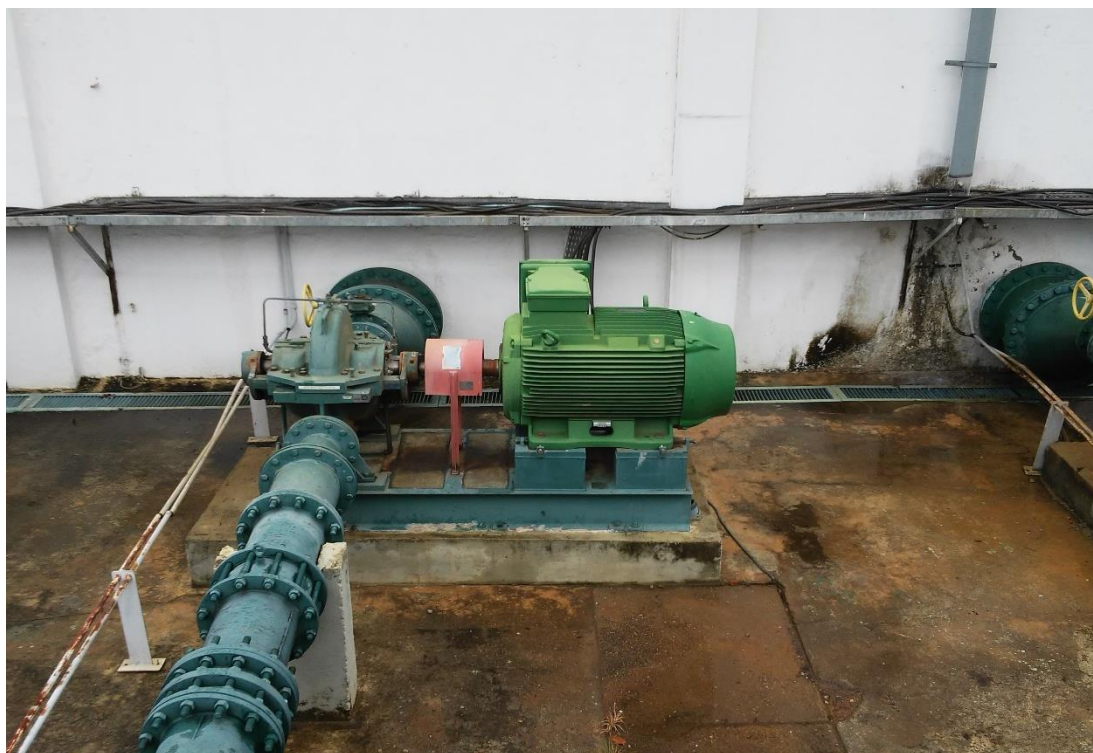
Figura 18: Conjunto Motorbomba atual ETA 006 Fonte: Próprio Autor.
