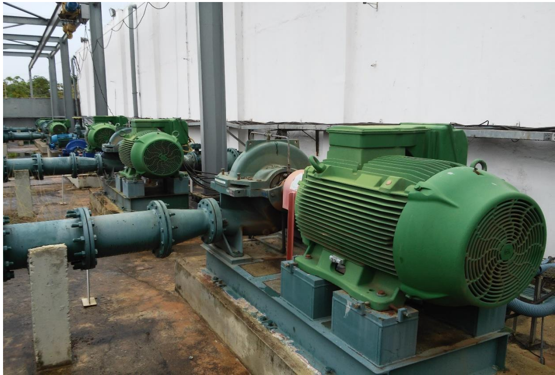
Figura 15: Conjunto Motorbomba atual ETA 006 Fonte: Próprio Autor.
