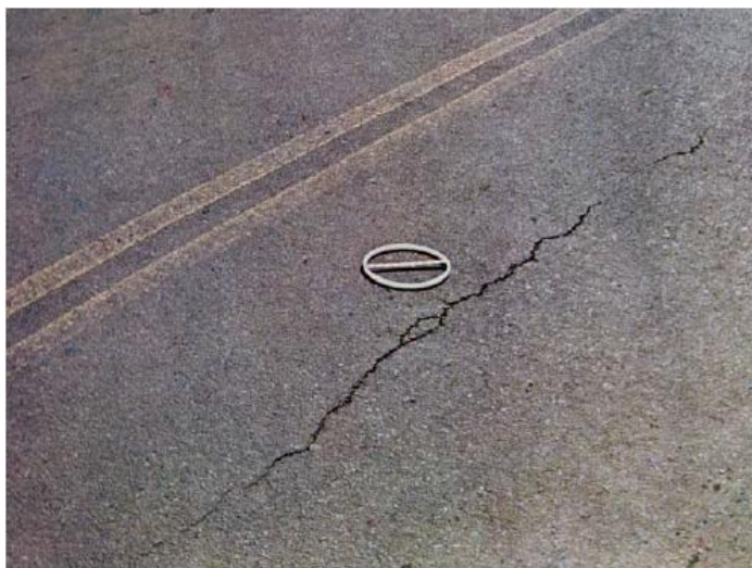
Figura 5 - Representação das trincas longitudinais.
