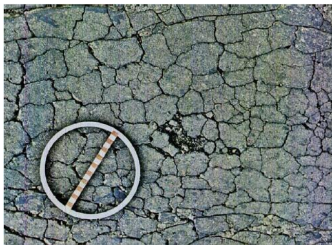
Figura 6 - Representação das trincas tipo couro de jacaré.
