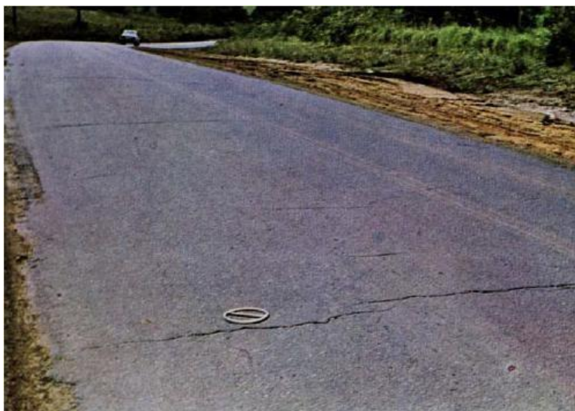
Figura 4 - Representação das trincas transversais.
