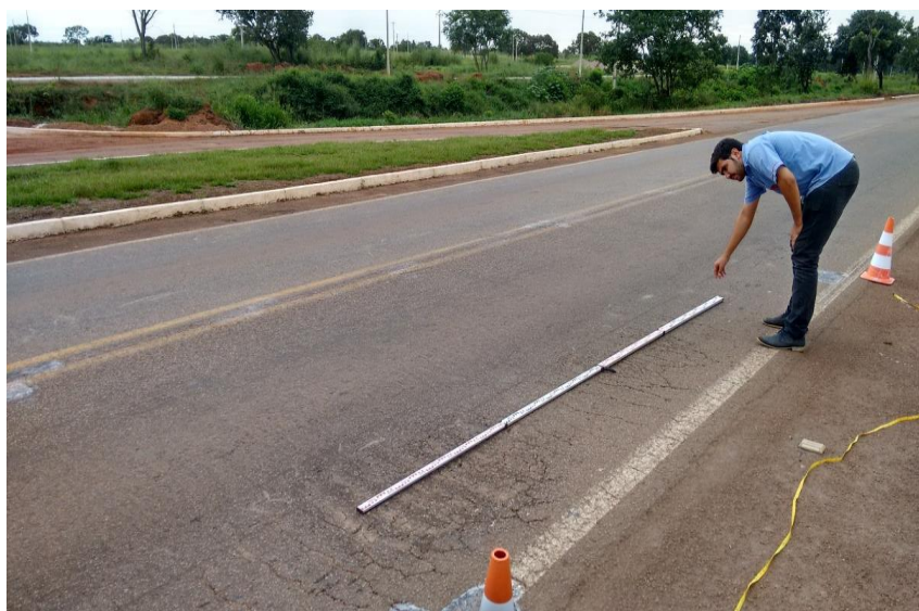
Figura 27 – Afundamento da trilha de roda
