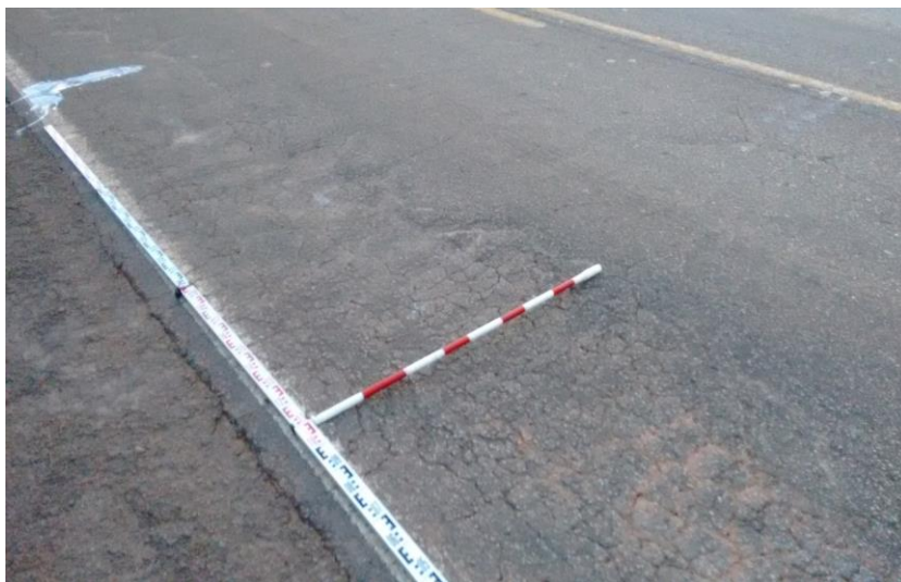
Figura 26 - Afundamento plástico com trincas interligadas tipo couro de jacaré
