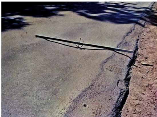
Figura 8 - Representação do afundamento nos trilhos de roda.
