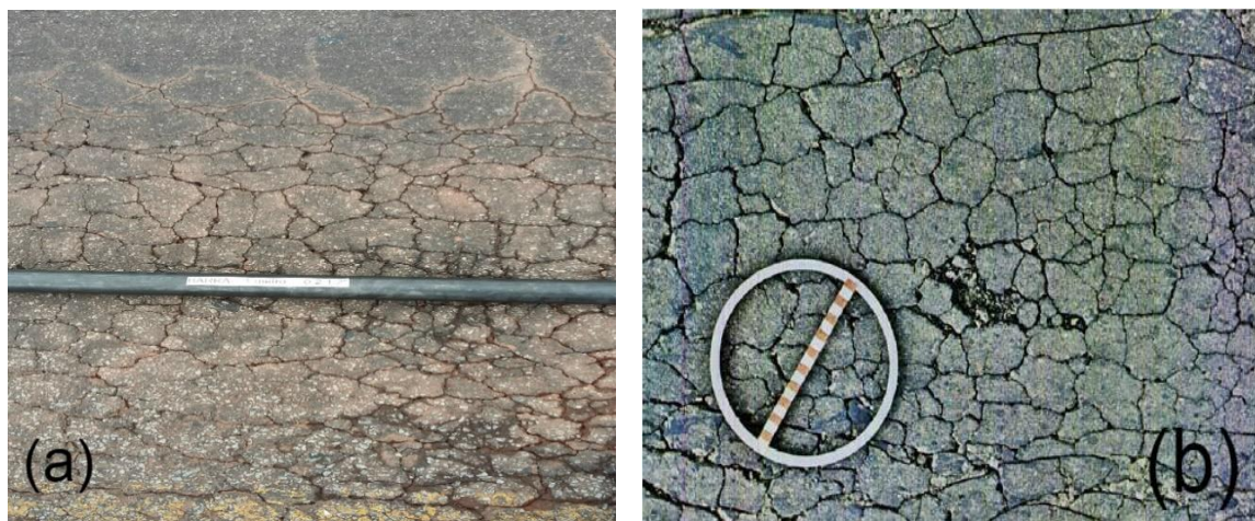
Figura 19 - (a) trinca tipo couro de jacaré -BR 153, entre Km 498 a Km 503 e (b) Imagem DNIT.
