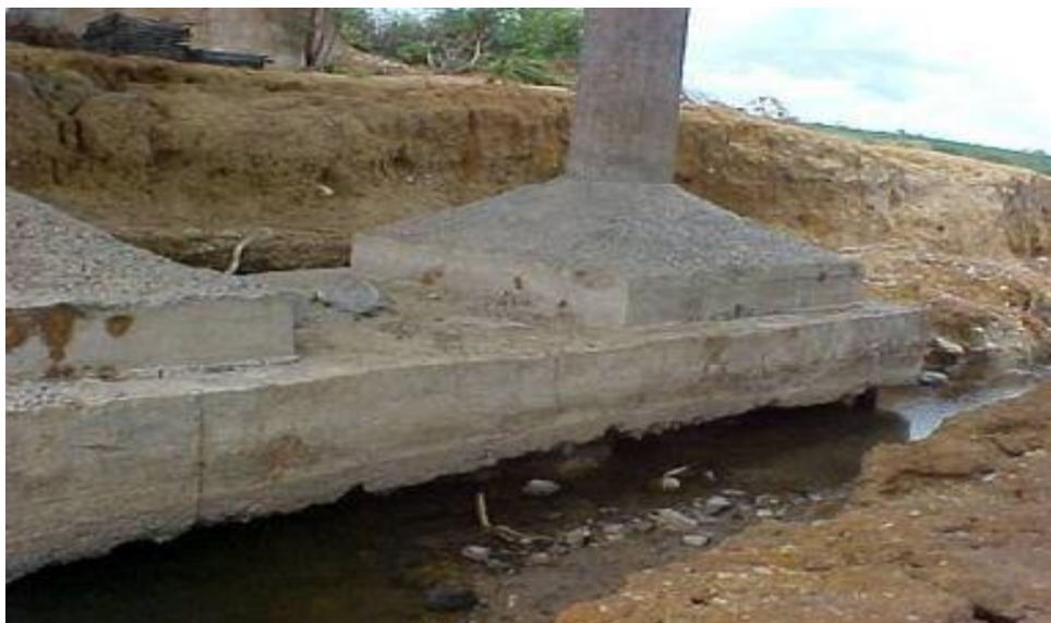
Figura 5 - Fuga de material sob as sapatas causando risco de colapso da ponte.(Fonte: VITÓRIO, 2014).
