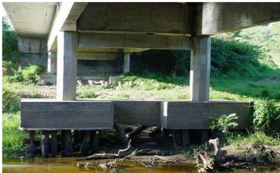
Figura 3 - Estacas expostas e desconfiadas por causa do rebaixamento do leito do rio. (Fonte: VITÓRIO, 2014).
