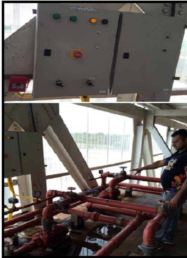
Figura 41 – Quadros de Comando das Bombas / Quadro Geral de Consumo
