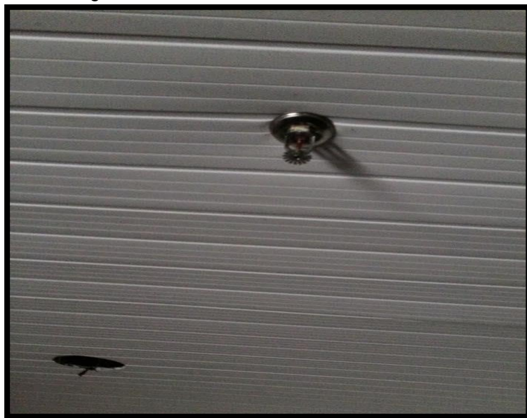
Figura 28 – Chuveiros Automáticos Auditório B.
