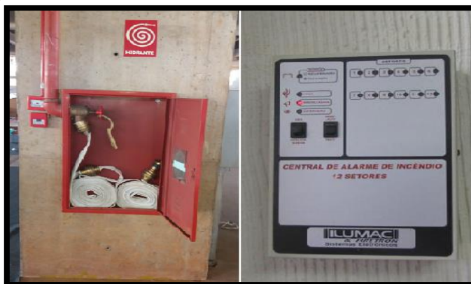
Figura 40 - Acionadores de Bomba e Alarme / Central de Alarme.
