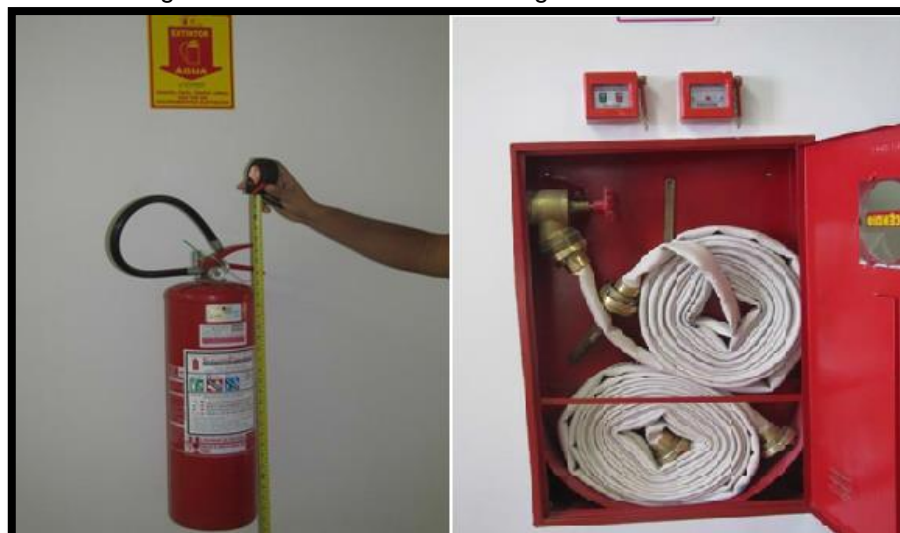
Figura 18- Extintor e Hidrante Regularmente Instalados
