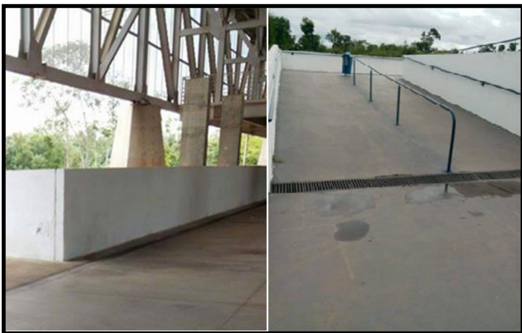
Figura 33– Muros de Contenção do Salão e das rampas de acesso ao térreo
