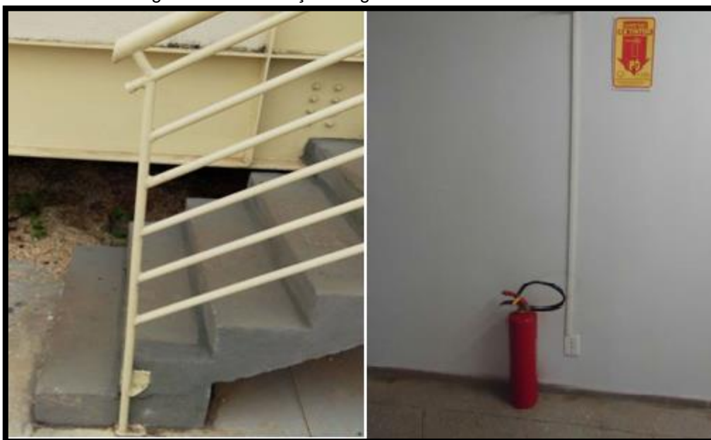
Figura 16 – Instalação irregular de Corrimão e Extintor
