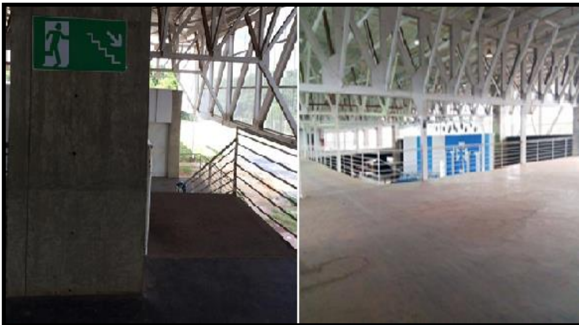
Figura 37 – Sinalização de emergência e Guarda - Corpos Inadequados
