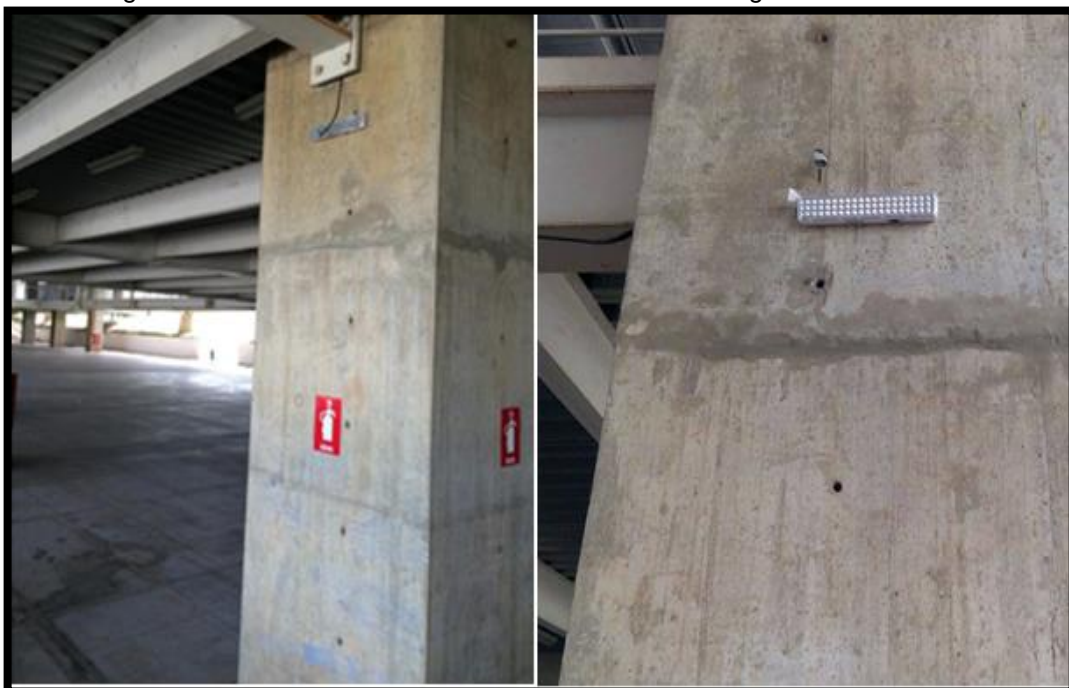
Figura 32– Extintores de Incêndio e Luminária de Emergência desinstalada.
