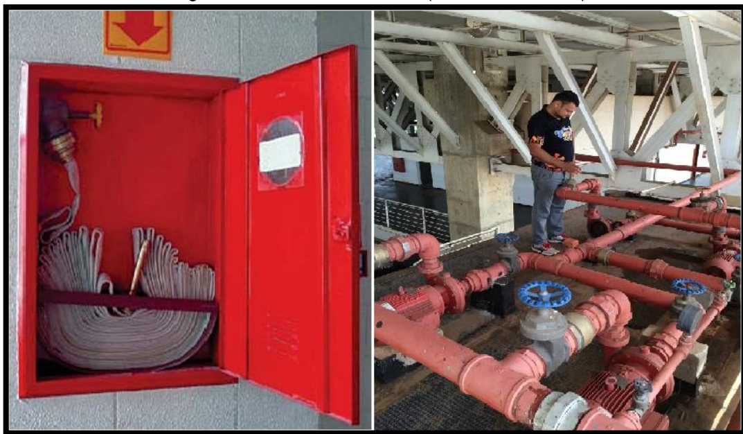
Figura 11 - Sistema Hidráulico (Hidrante e Bomba)
