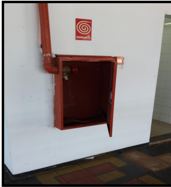
Figura 17- Hidrante com instalação irregular
