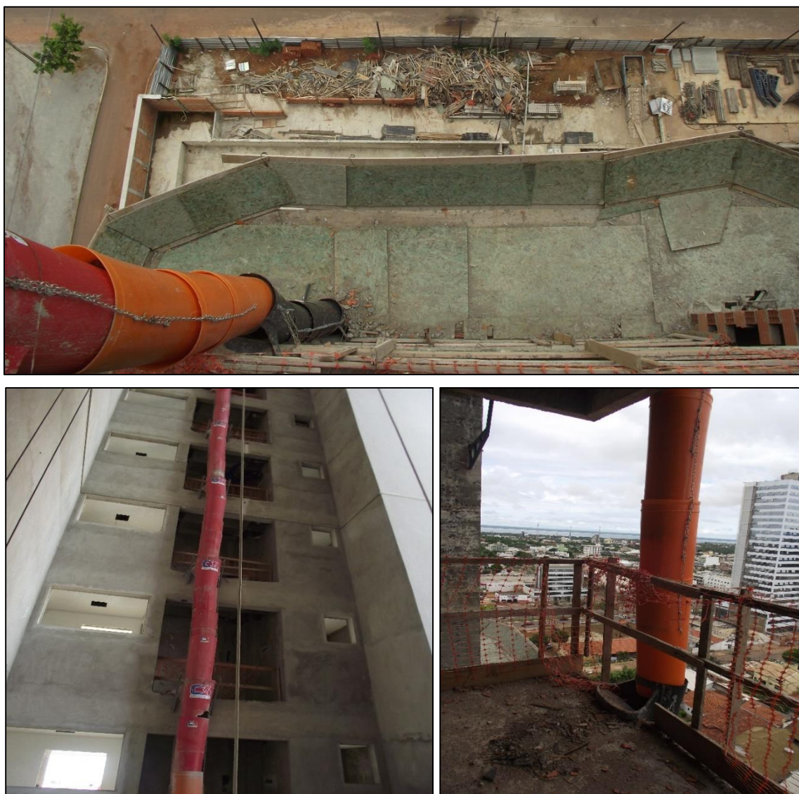
Figura 17 – Dutos para transporte vertical dos RCD ao container
