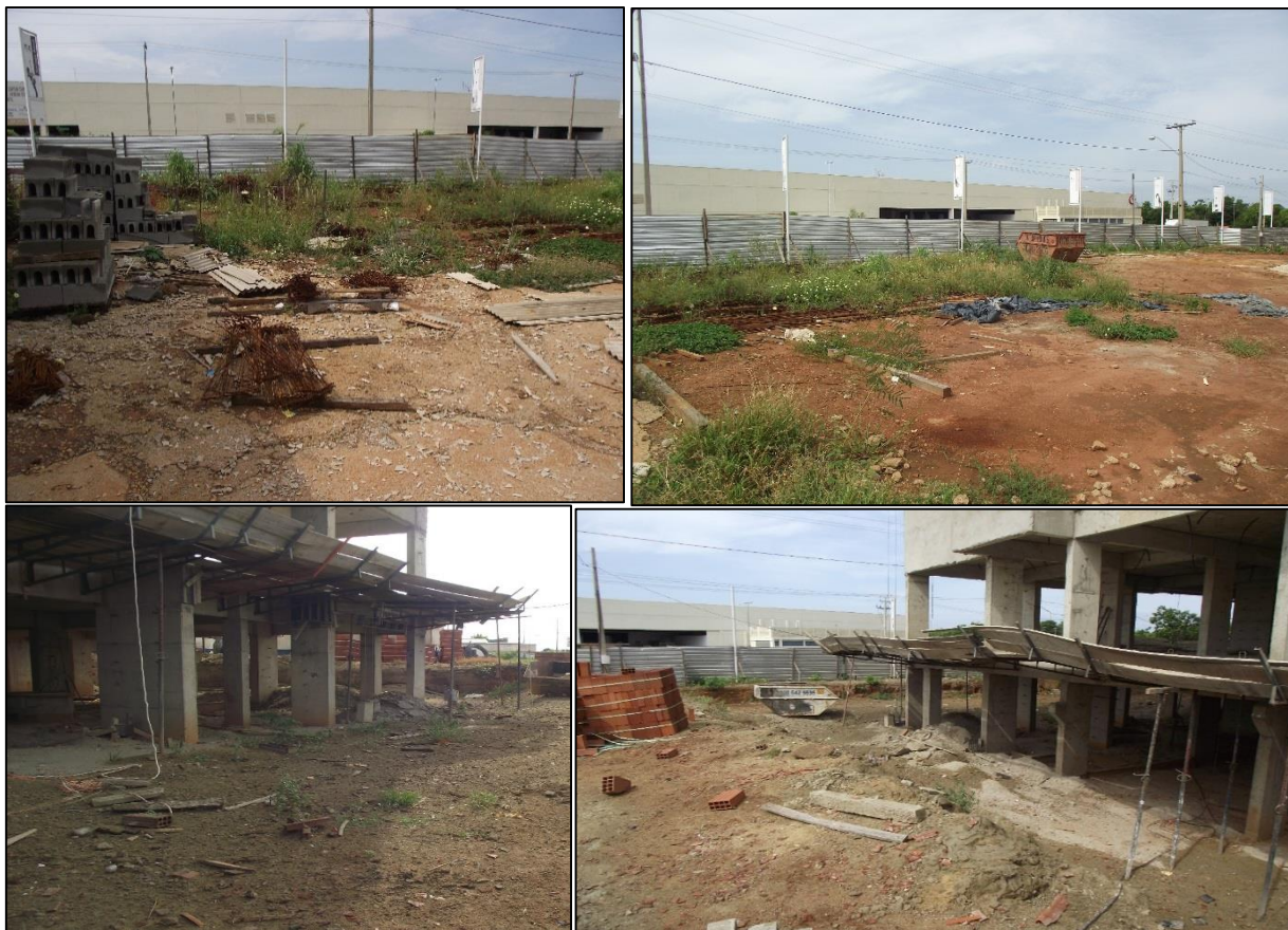
Figura 12 – Pontos do canteiro com desperdício e organização ineficiente
