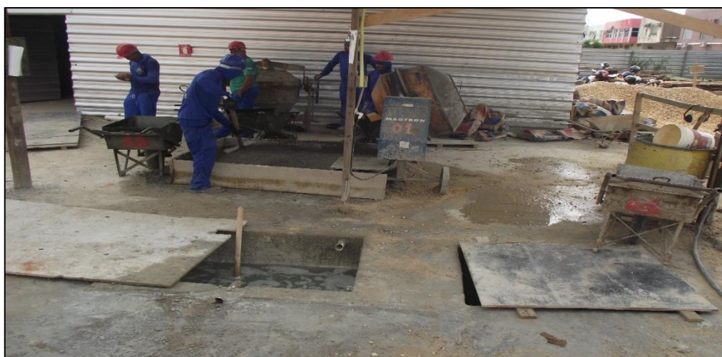
Figura 19 – Sistema de decantação da água utilizada na betoneira
