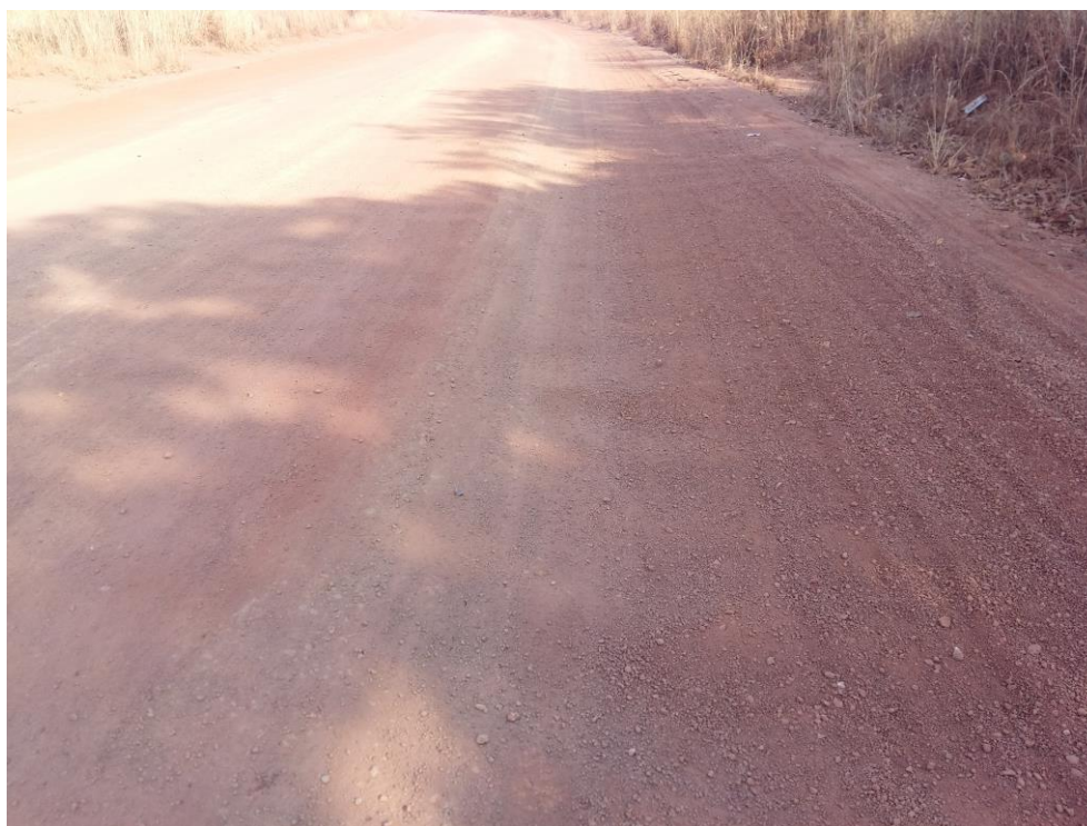
Figura 44: Trecho com segregação de agregados
