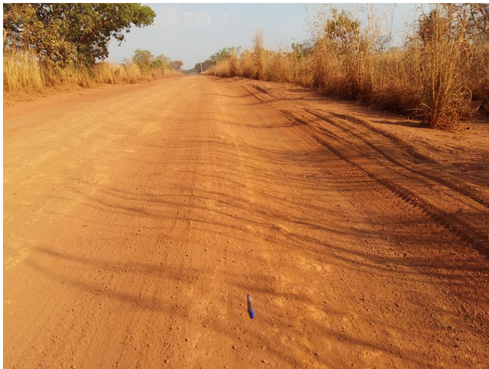
Figura 38: Trecho com seção transversal imprópria
