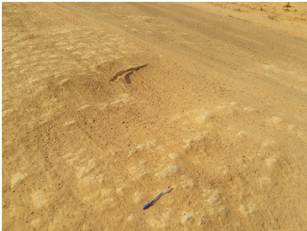
Figura 42: Trecho com buracos
