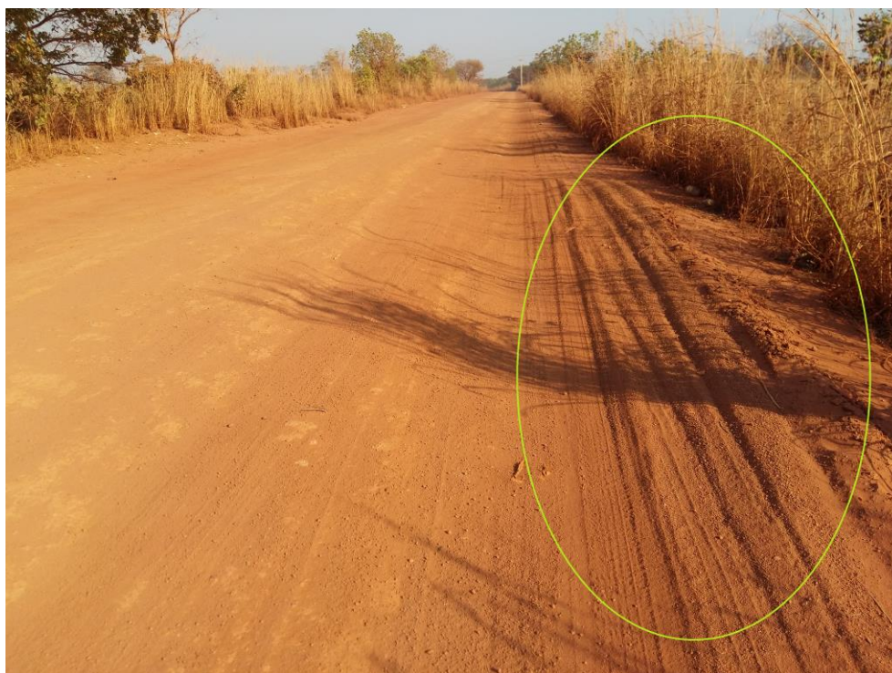
Figura 39: Trecho com drenagem lateral inadequada
