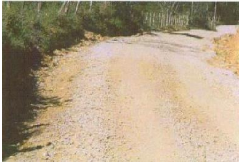
Figura 13: Perda de agregados
