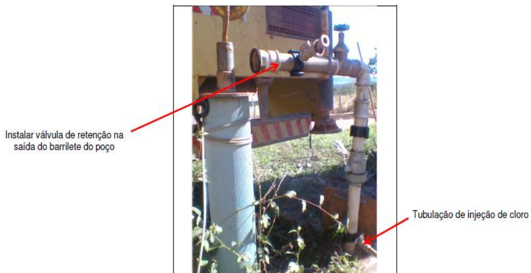
Figura 27 - Sistema de desinfecção - clorador de pastilha - adaptado no barrilete onde foi instalado a válvula de retenção.
