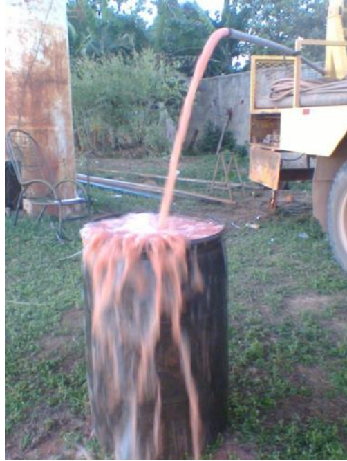
Figura 24 - Início do teste de vazão, condição turva da água bombeada e produção de sedimento - areia.
