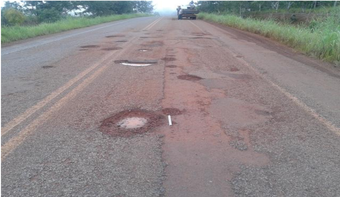
Figura 22- Buracos e desgaste
