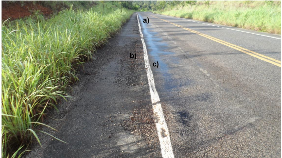
Figura 11- Desgaste, afundamento e trincas.
