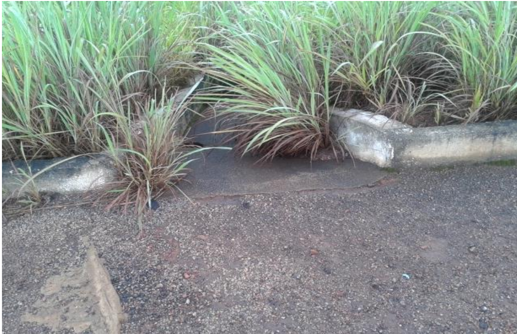
Figura 38- Descidas de água
