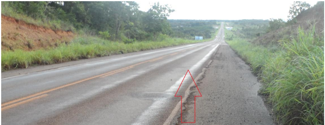
Figura 10- Afundamento de Consolidação de trilhas de rodas
