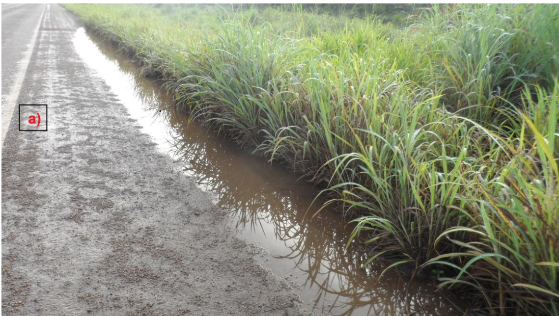
Figura 41- Água empoçada no acostamento
