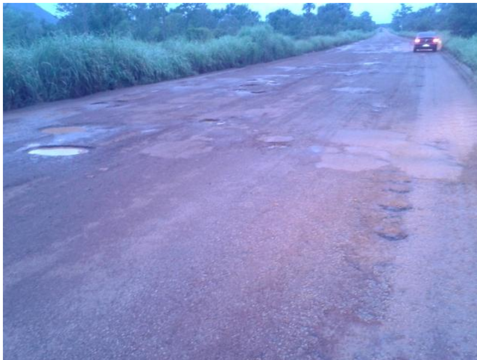
Figura 23- Trecho desgastado com buracos e remendos
