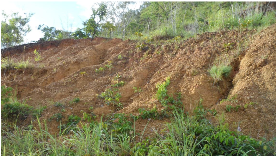
Figura 29- Aproximação da erosão no talude de corte
