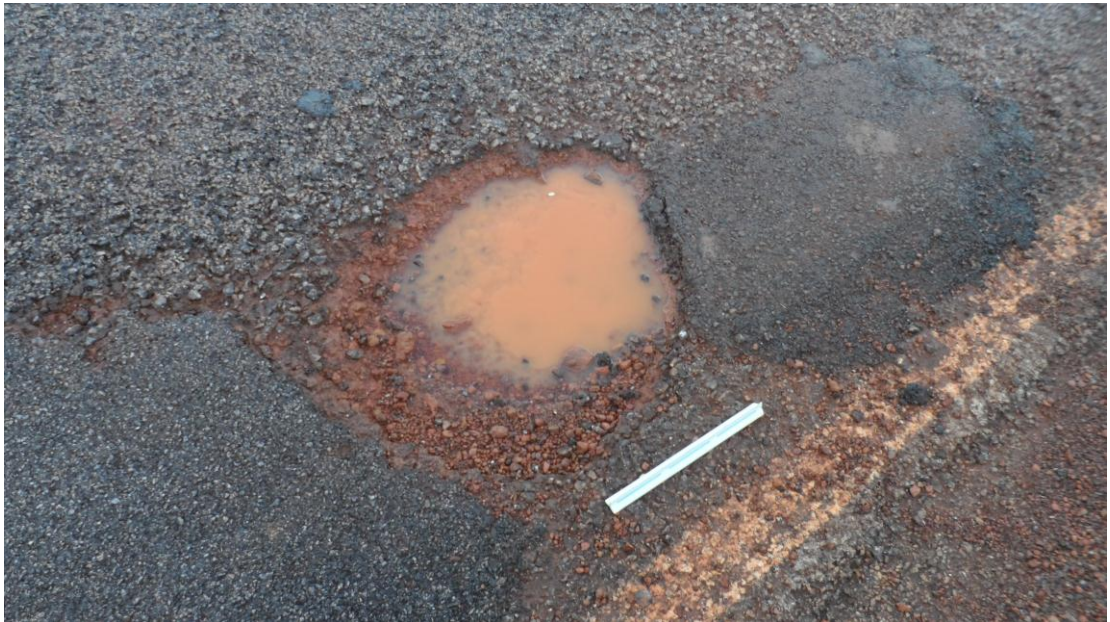
Figura 24- Buraco entre remendos
