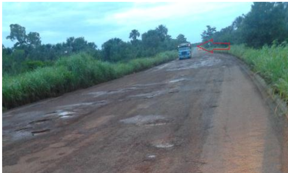
Figura 8- Transporte de carga transitando em pavimento defeituoso
