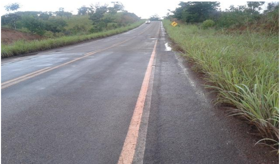
Figura 19- Aproximação do ponto de concentração dos defeitos da figura 18
