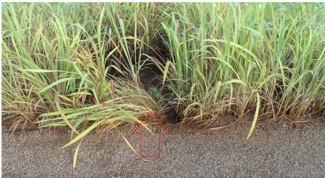
Figura 39- Estado de conservação de descidas de água
