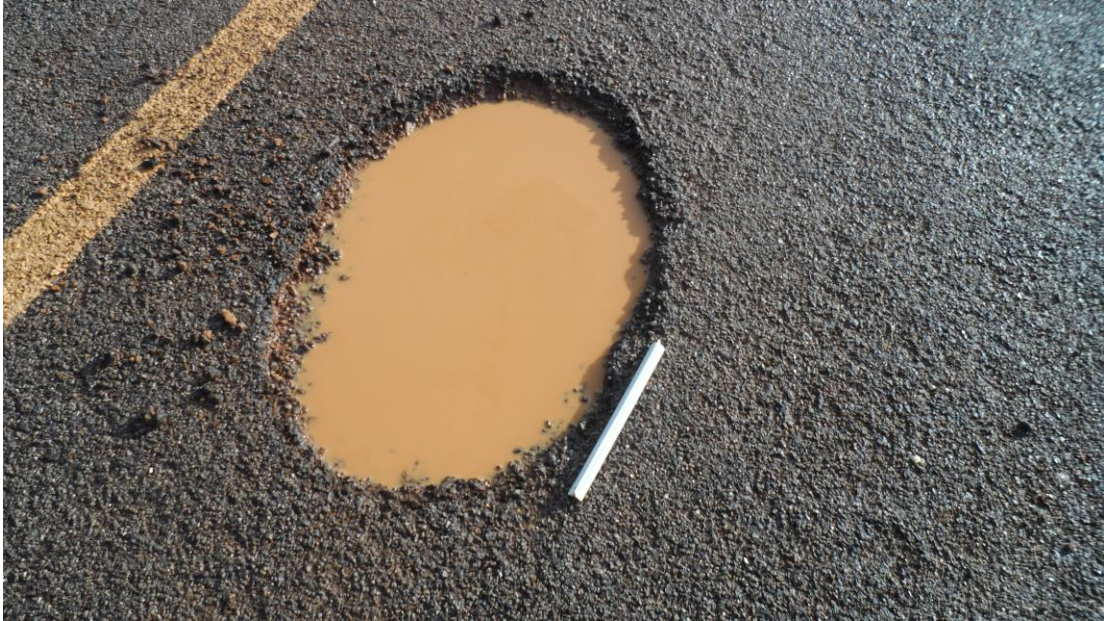
Figura 20- Painha isolada no pavimento
