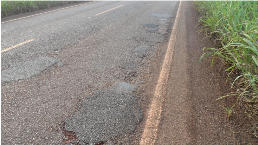
Figura 25- Revestimento poroso com remendos
