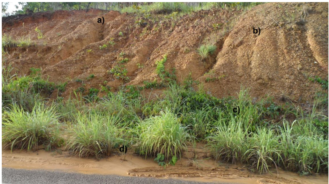
Figura 9-Erosão em Talude de Corte
