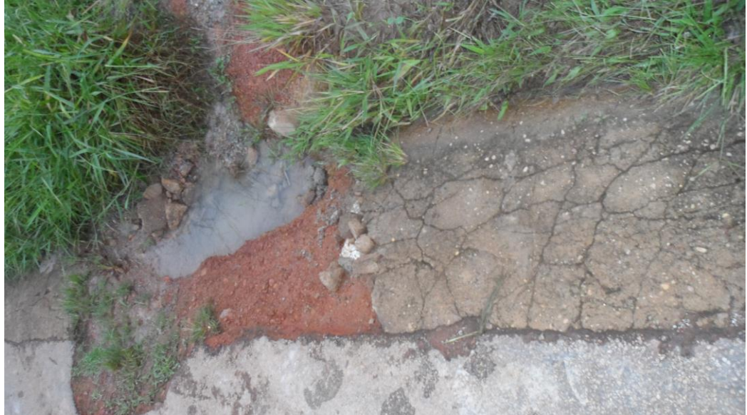
Figura 36- Aproximação do estado de conservação da sarjeta de corte
