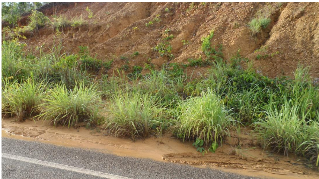
Figura 37- Ausência de sarjeta e presença de lama no acostamento
