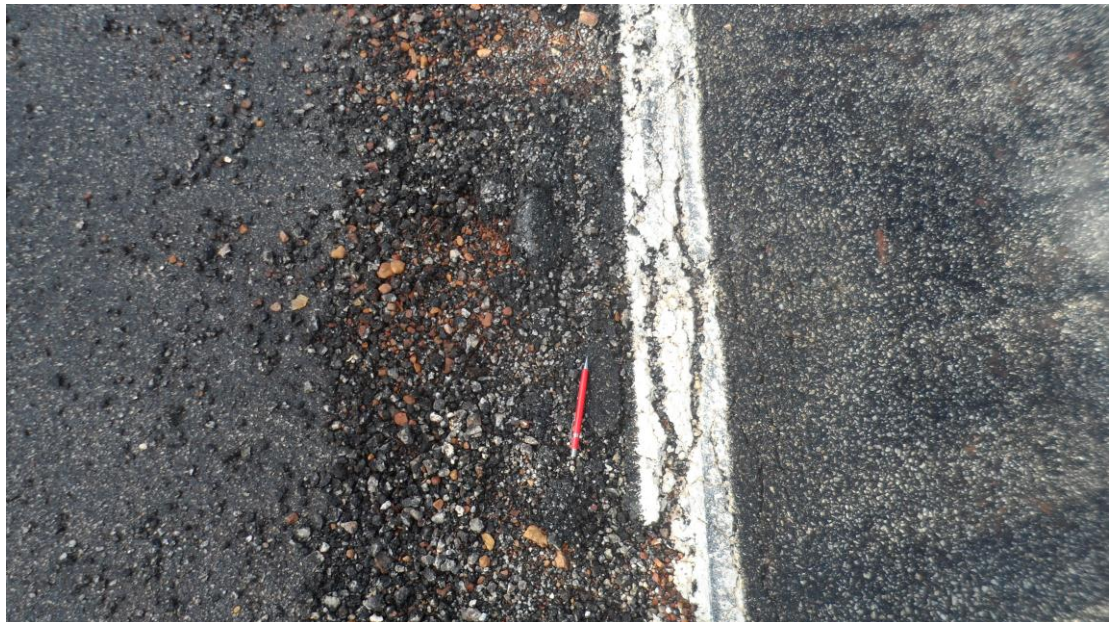
Figura 12- Desgaste e trincas
