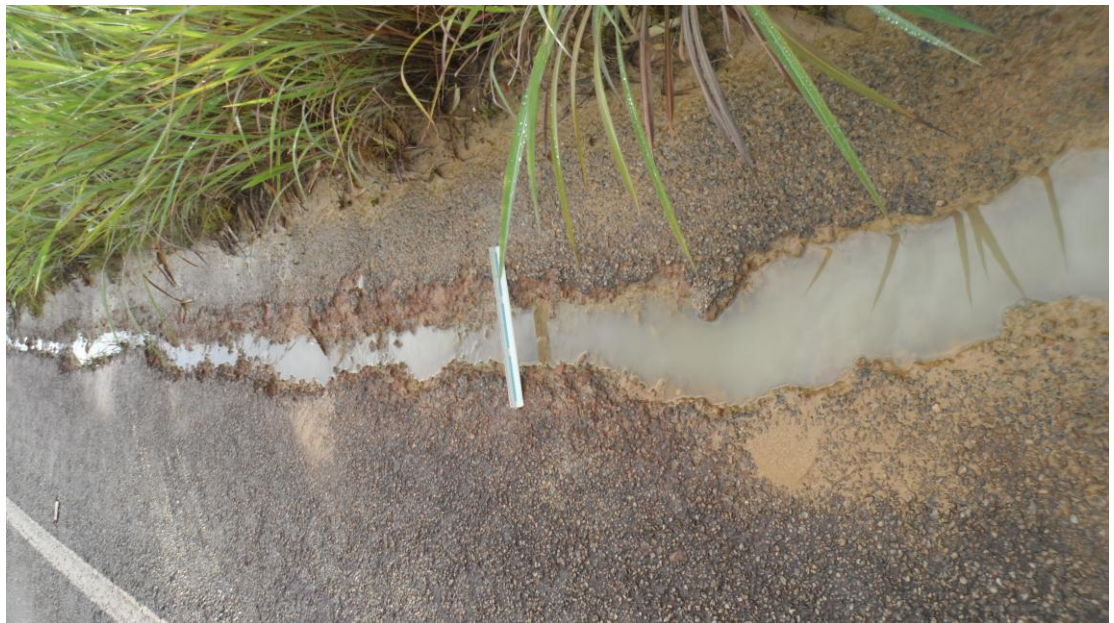
Figura 17- Erosão superficial em acostamento
