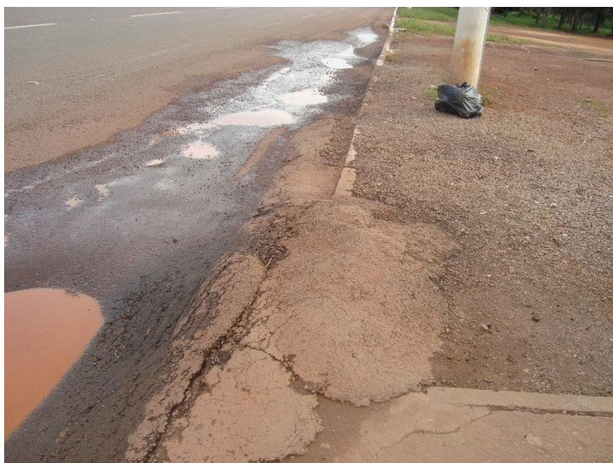
Figura 24: Escorregamento- Estação Krahô.
