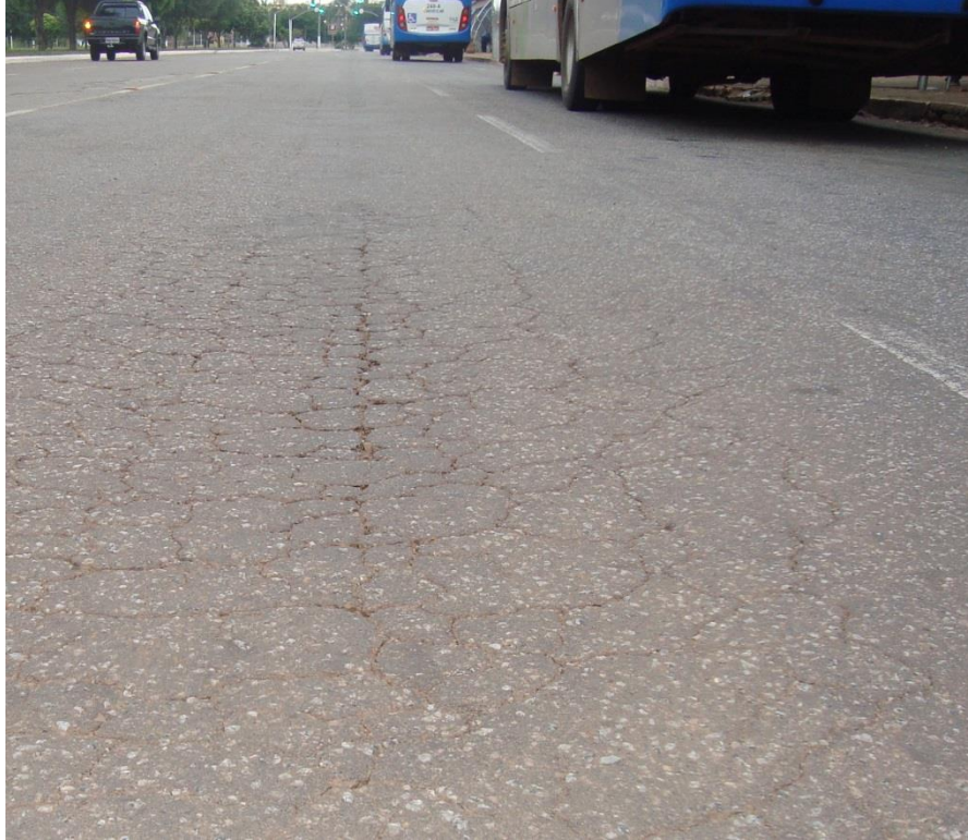
Figura 33: Trinca interligada tipo couro de jacaré-Estação Apinajé.
