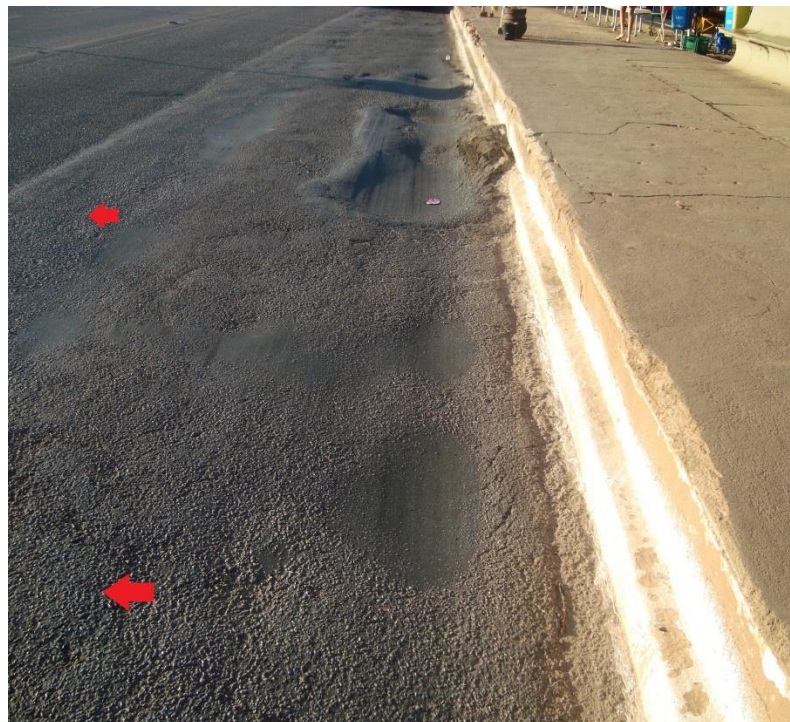
Figura 30: Desgaste- Estação Xambioá.
