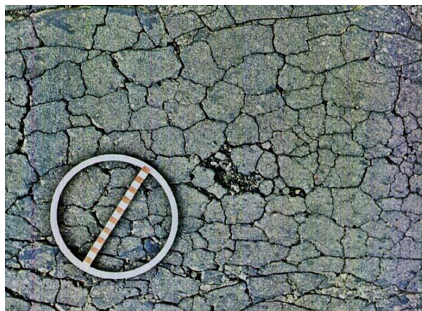
Figura 5: Trinca interligada- tipo jacaré.
