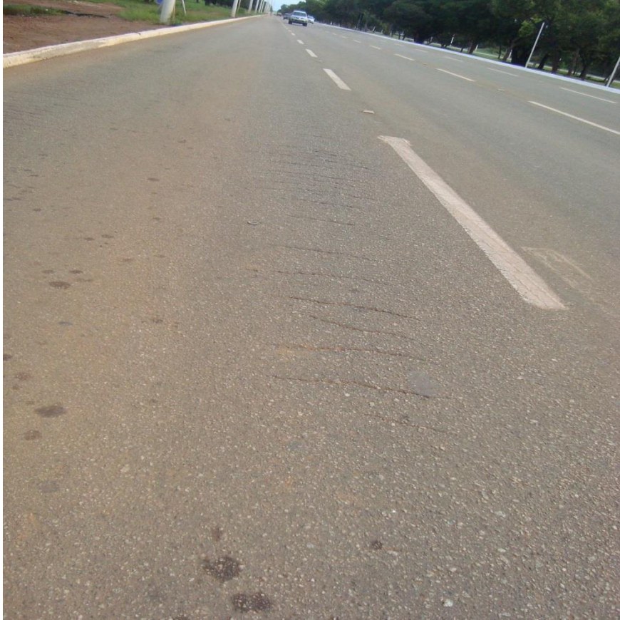
Figura 22: Afundamento da trilha de roda- antes da Estação Krahô.
