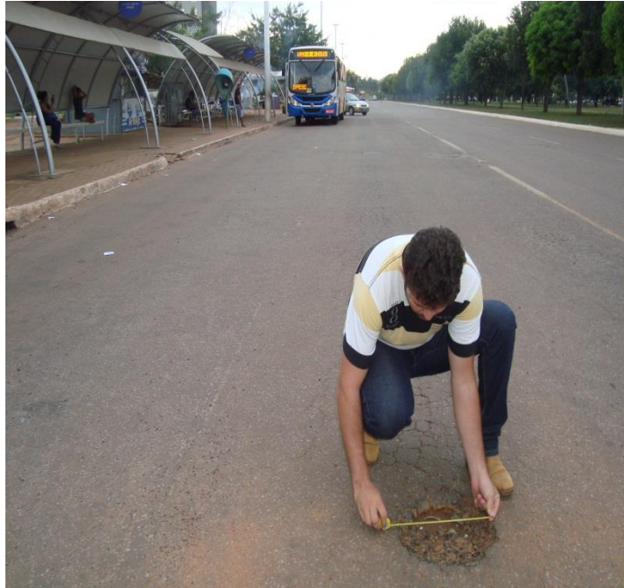
Figura 32: Panela- Estação Apinajé.
