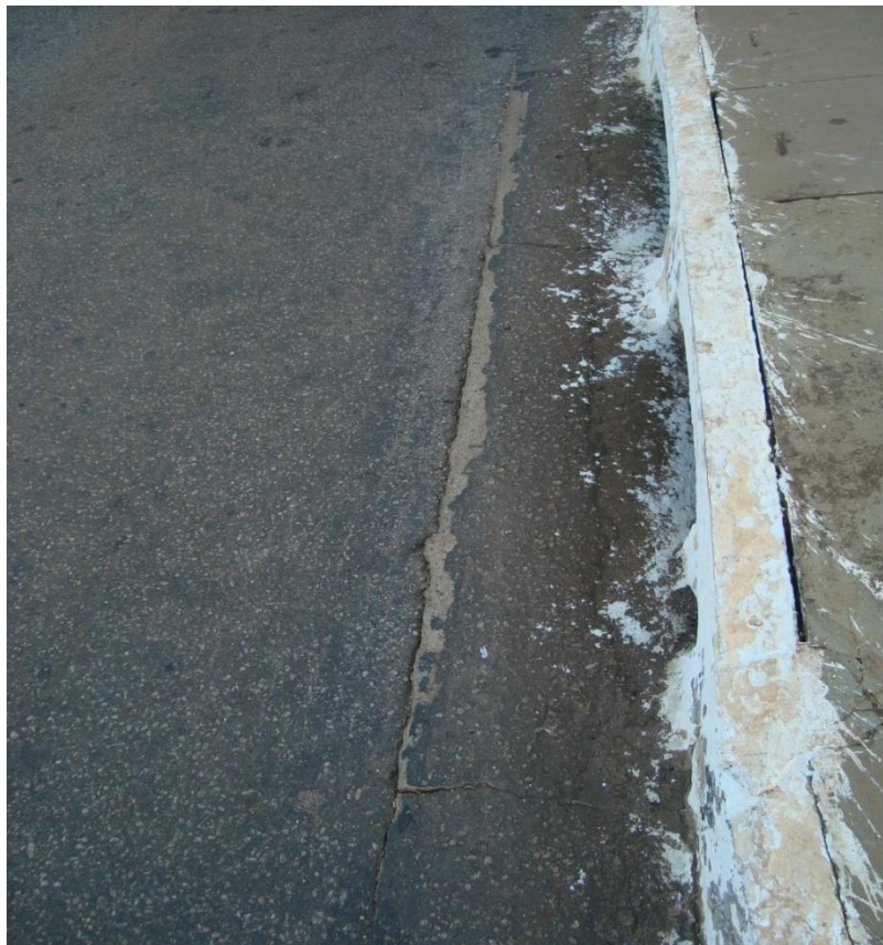
Figura 36: Trinca isolada longitudinal longa.
