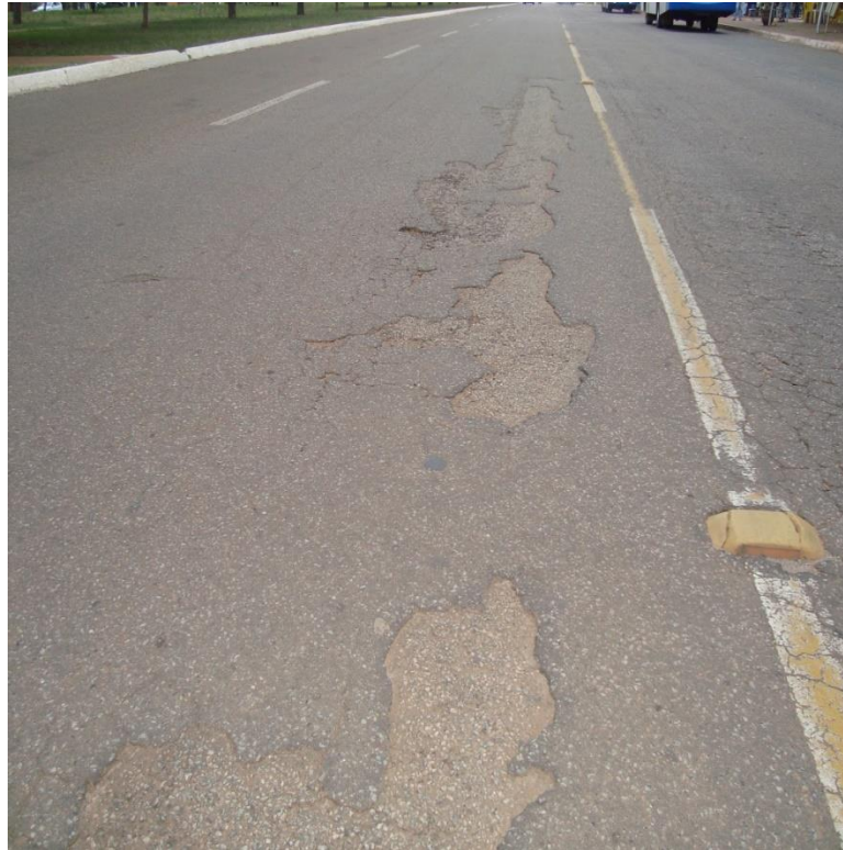
Figura 34: Exsudação- Estação Apinajé.
