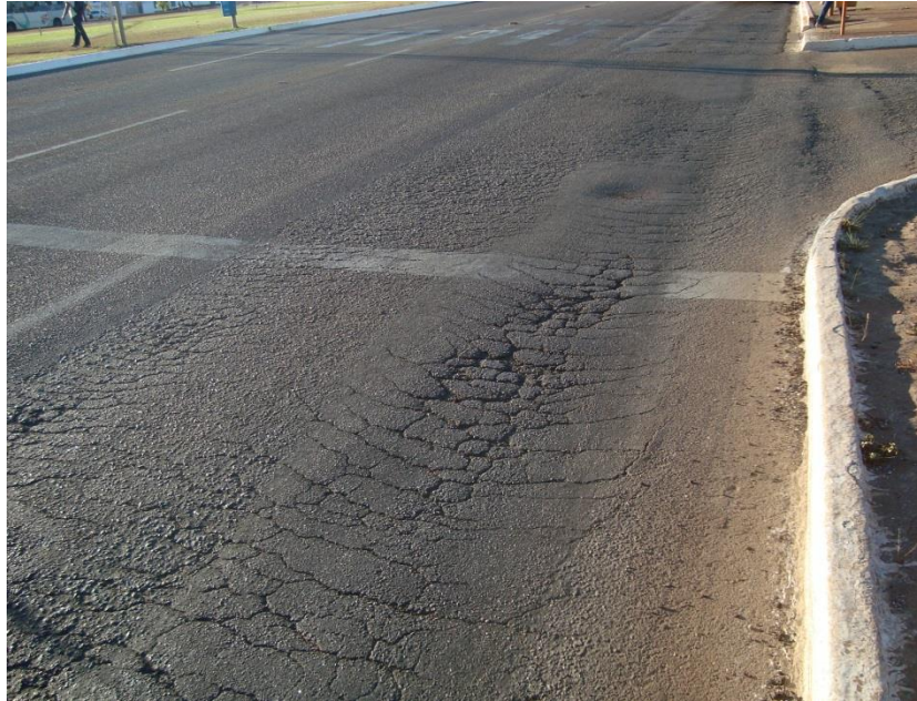
Figura 26: Trinca interligada – Tipo couro de jacaré- Estação Xambioá.
