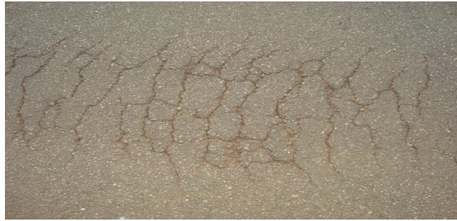
Figura 19: Trinca interligada-tipo couro de jacaré na estação Krahô.
