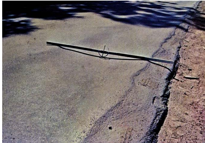
Figura 6: Afundamento de trilha de roda.
