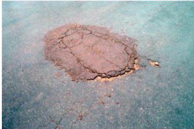
Figura 12: Remendo mal executado
