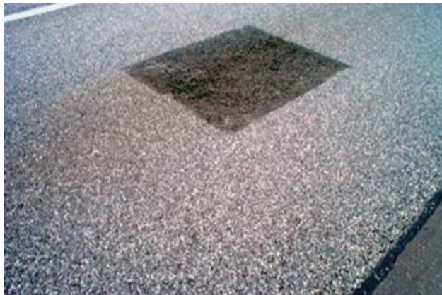
Figura 13: Remendo bem executado.
