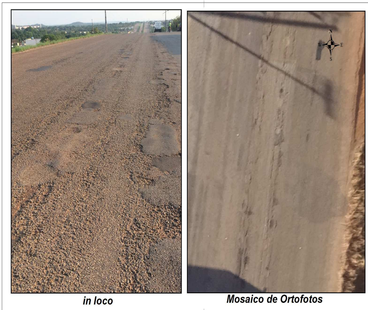
Figura 19 – Desgastes superficial Fonte: (A autora)
