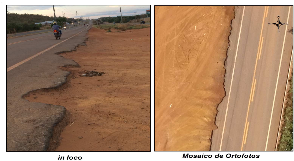
Figura 15 – Perda de revestimento de acostamento
