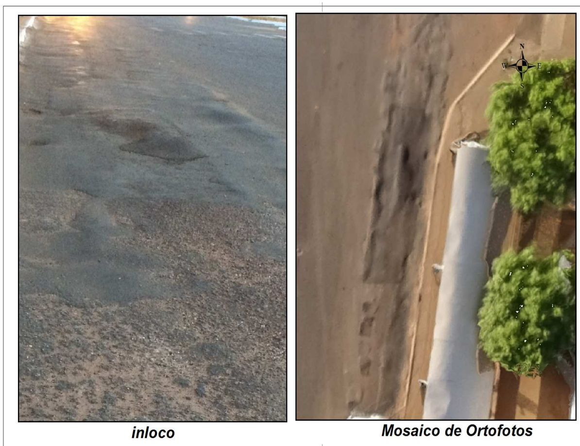
Figura 17 – Afundamento com sollevamento
