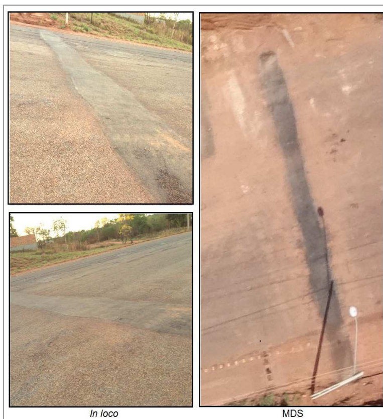
Figura 24 – Remendo de intervenções em redes subterrâneas
