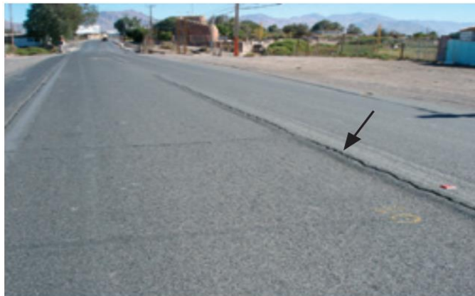
Figura 7 - Trinca de retração
