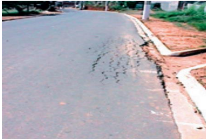
Figura 11 - Afundamento plástico da trilha de roda
