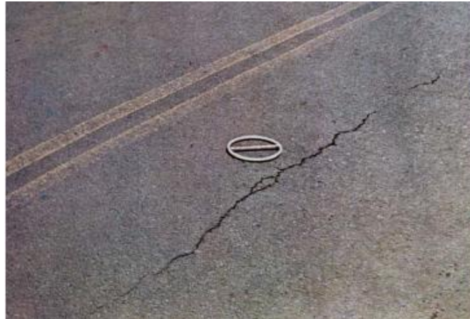
Figura 6 - Trinca longitudinal isolada
