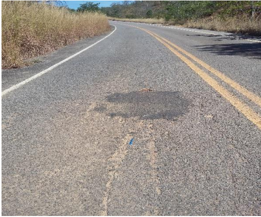
Figura 26 - Remendo mal executado
