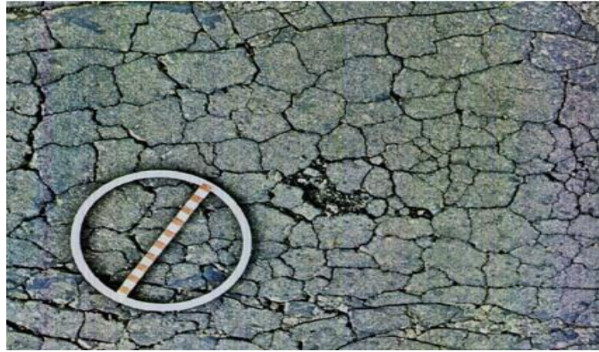
Figura 8 - Trinca interligada tipo “Couro de Jacaré”
