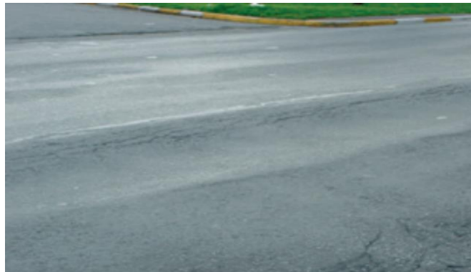
Figura 10 - Afundamento plástico da trilha de roda
