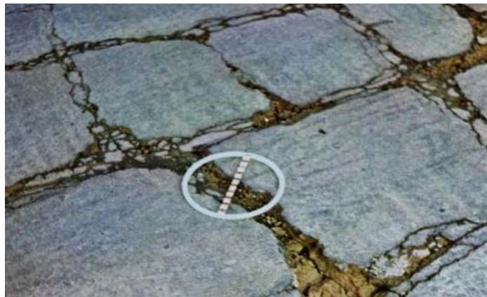
Figura 9 - Trinca interligada tipo bloco
