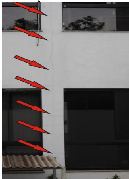
Figura 49– Fissuras característica de dilatação térmica na posição esperada da junta de dilatação vertical do bloco B.
