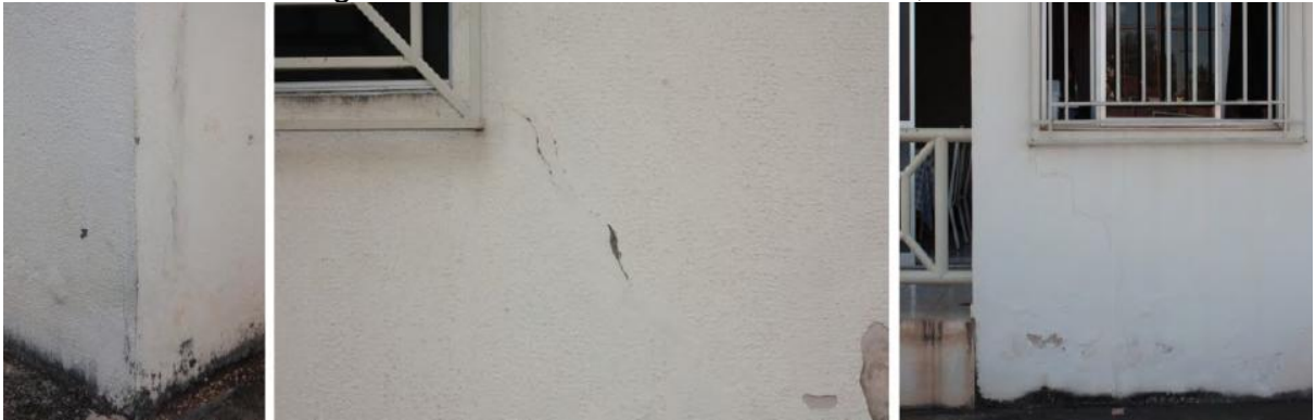
Figura 36– Fissuras característica de dilatação higrotermica de vergaws e contra vergas no restimento da fachada bloco A, B e C.
