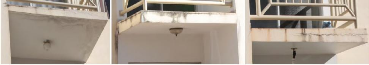
Figura 29– Degradação do revestimento das lajes das sacadas do Bloco C por falha de impermeabilização e ausência de dispositivo de proteção contra intempéries.
