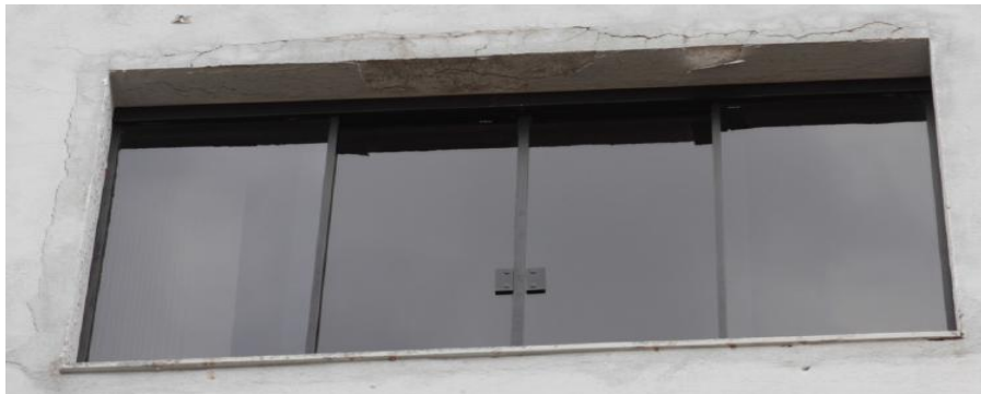
Figura 51– Fissuras de retração e dilatação térmica no contorno de esquadria do bloco A.
