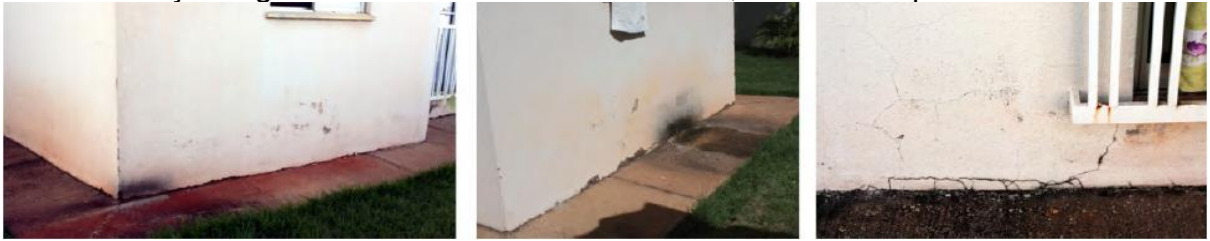
Figura 18 – Sujidades, vesículas, desprendimento de película de pintura e fissuras de dilatação higrotérmica na fachada do bloco 6, no nível do pavimento térreo.
