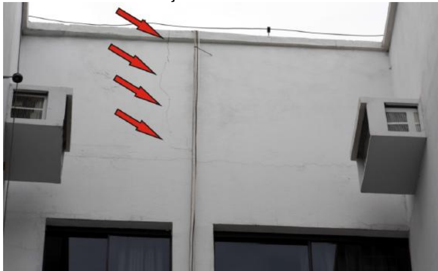
Figura 50– Fissuras característica de dilatação térmica na posição esperada da junta de dilatação vertical do bloco B.
