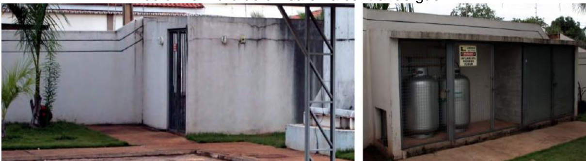
Figura 21– Fissuras características de dilatação higrotérmica, sujidades, mofo e bolor no muro de divisa e na central de gás.
