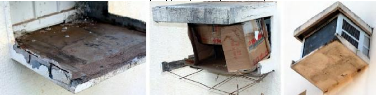
Figura 34– Degradação dos suportes dos condicionadores de ar tipo janela nos blocos A (esq.), B (centro), e C (dir.).
