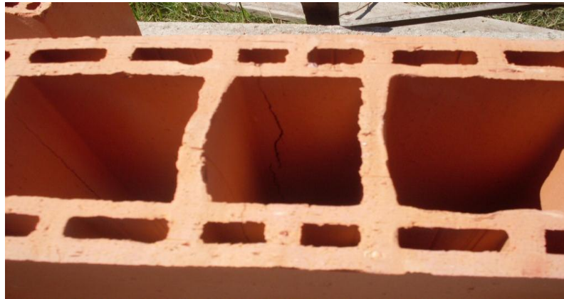
Figura 03 - Bloco que apresenta trincas verticais provenientes da fabricação – vista interna.
