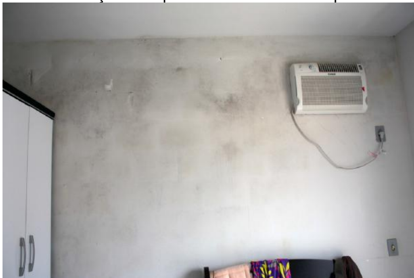
Figura 57– Mofo e infiltrações em painel de alvenaria de apartamento do bloco A.
