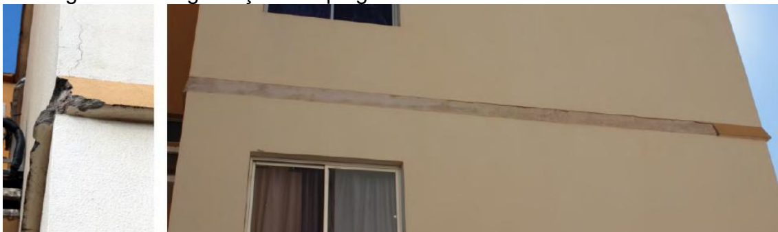
Figura 24– Degradação das pingadeiras de fachada dos blocos A e D.
