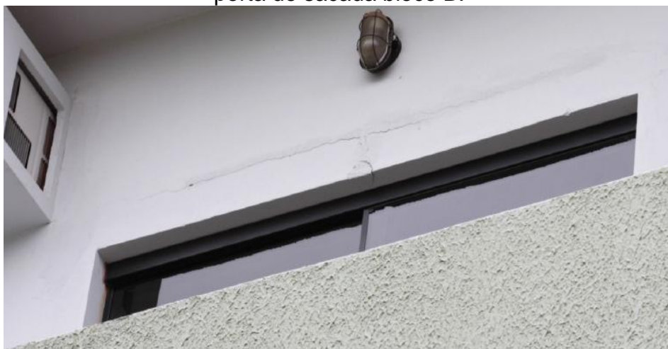
Figura 52– Fissuras de retração e dilatação térmica em extremidade superior de porta de sacada bloco B.
