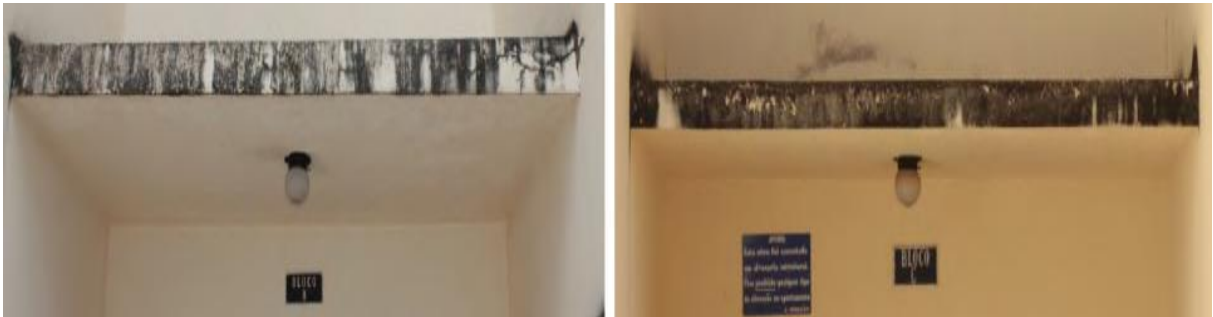
Figura 40– Mofo e sujidades de dilatação higrótérmica na laje de cobertura do hall dos blocos B e C.
