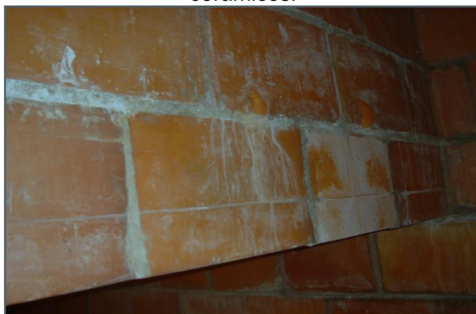
Figura 02 – Parede apresentando sinais de eflorescência devido a trincas nos blocos cerâmicos.
