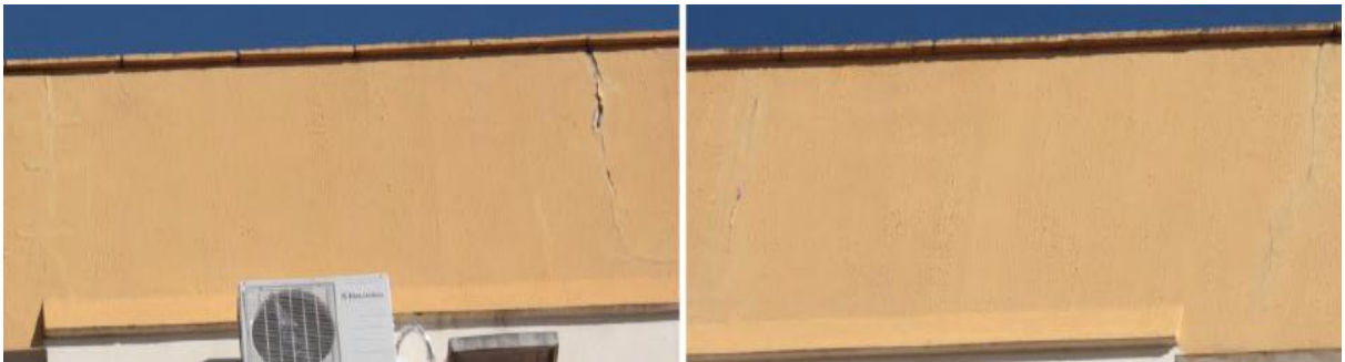
Figura 31– Degradação do revestimento das platibandas pela percolação de água bloco C e D.
