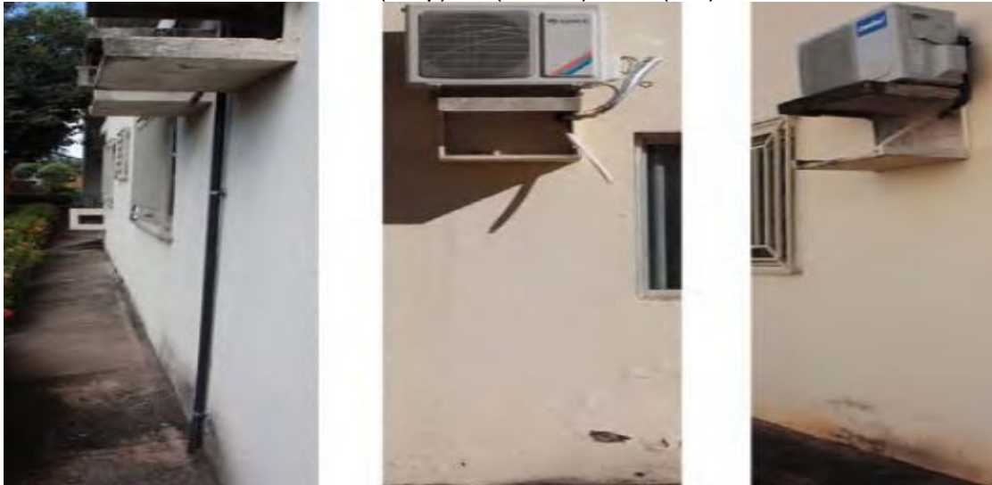
Figura 43– Sujidades na fachada do edifício no nível do pavimento térreo acarretadas pelo lançamento da água dos drenos do sistema de ar condicionado no bloco A (esq.), B (centro), e C (dir.).
