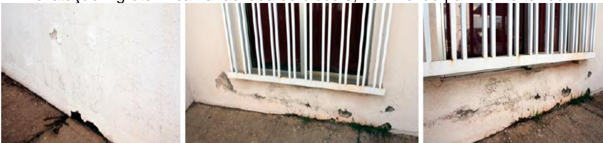
Figura 20– Sujidades, vesículas, desprendimento de película de pintura e fissuras de dilatação higrotérmica na fachada do bloco 8, no nível do pavimento térreo.
