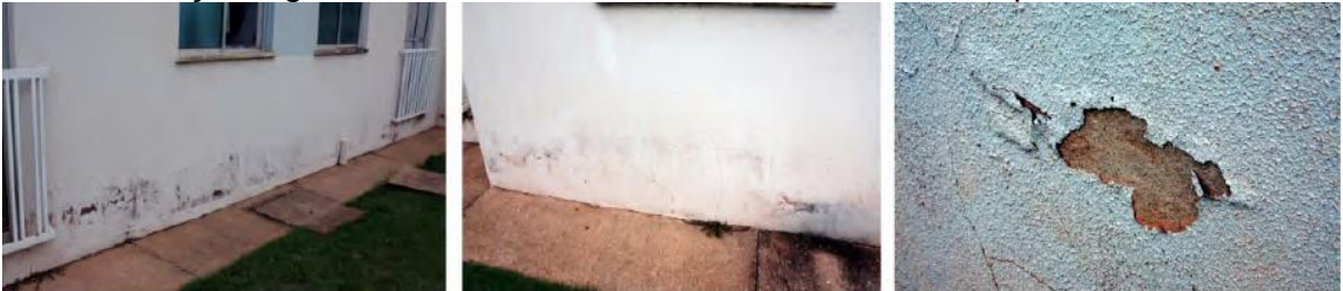
Figura 15 – Sujidades, vesículas, desprendimento de película de pintura e fissuras de dilatação higrotérmica na fachada do bloco 2, no nível do pavimento térreo.
