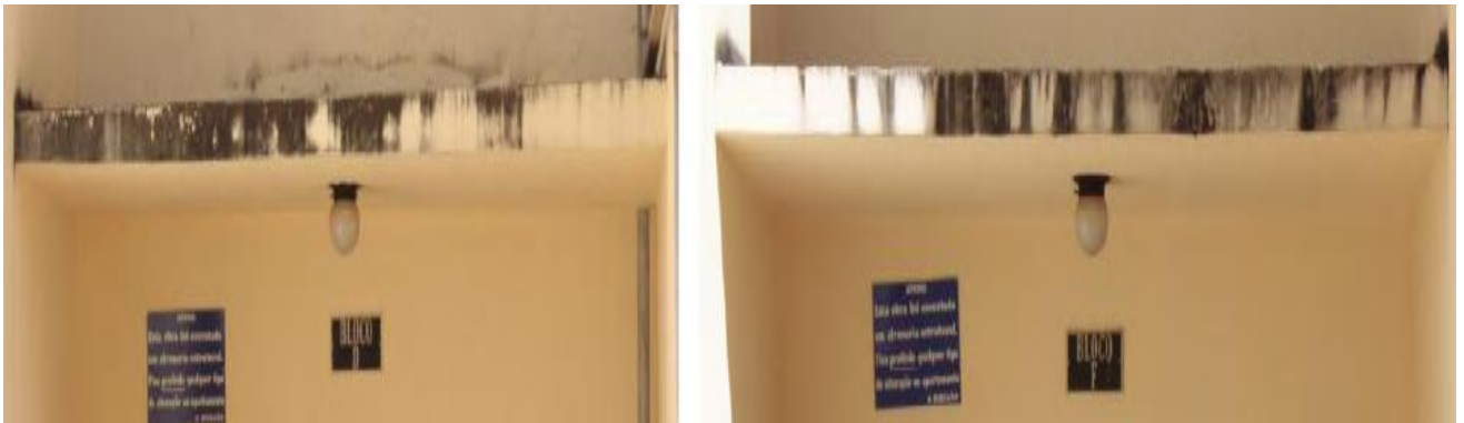
Figura 41– Mofo e sujidades de dilatação higrótérmica na laje de cobertura do hall dos blocos D e F.
