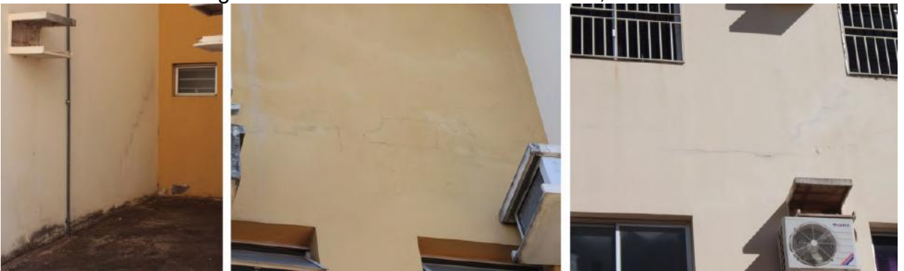
Figura 37– Fissuras característica de dilatação higrotermica de vergaws e contra vergas no restimento da fachada bloco D, E e F.
