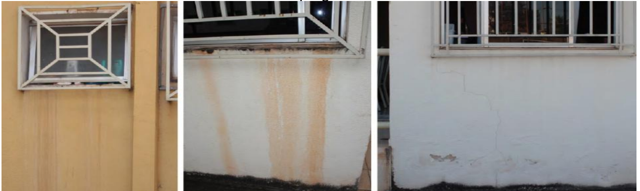
Figura 39– Machas e fissuras de dilatação higrótérmica no revestimento da fachada devido à ausência de pingadeiras no bloco A.
