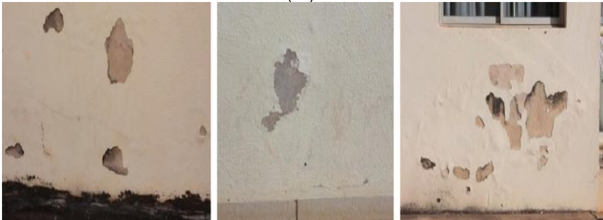
Figura 44– Sujidades, vesículas, desprendimento de película de pintura e fissuras de dilatação higrotérmica, pavimento térreo do bloco A (esq.), B (centro), e do bloco C (dir).
