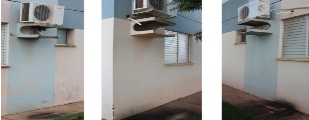
Figura 23– Sujidades na fachada do edifício no nível do pavimento térreo.
