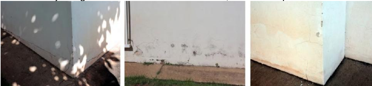
Figura 19 – Sujidades, vesículas, desprendimento de película de pintura e fissuras de dilatação higrotérmica na fachada do bloco 7, no nível do pavimento térreo
