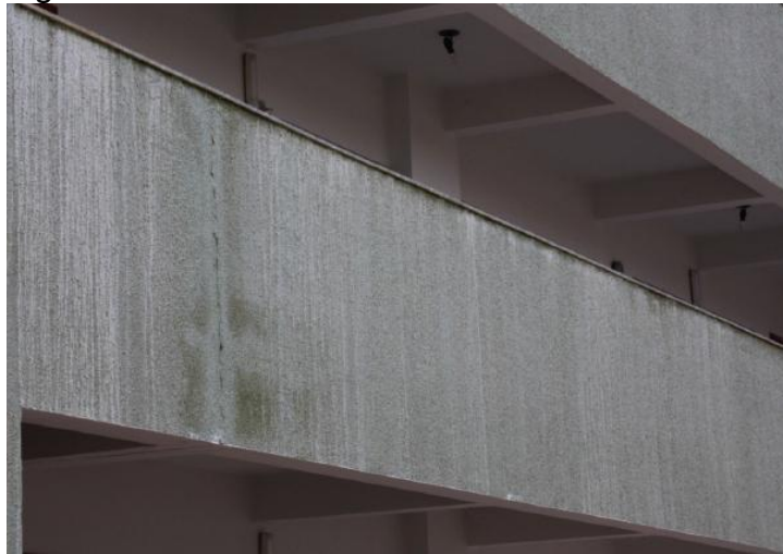
Figura 56– Manchas na textura acrílica do bloco A.
