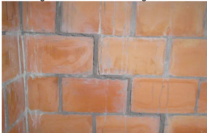
Figura: 04 - Fissuras na argamassa
