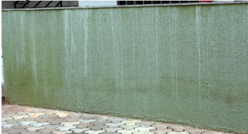
Figura 55– Manchas na textura acrílica do bloco A.
