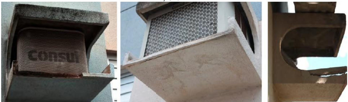
Figura 13 – Corrosão dos suportes dos condicionadores de ar tipo janela nos blocos 1, 5 e 7.
