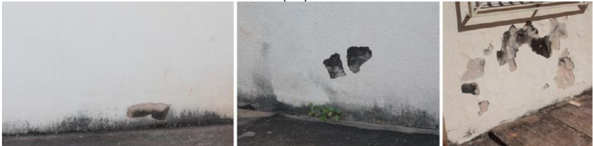
Figura 45– Sujidades, vesículas, desprendimento de película de pintura e fissuras de dilatação higrotérmica, pavimento térreo, no bloco D (esq.), E (centro), e do bloco F (dir).
