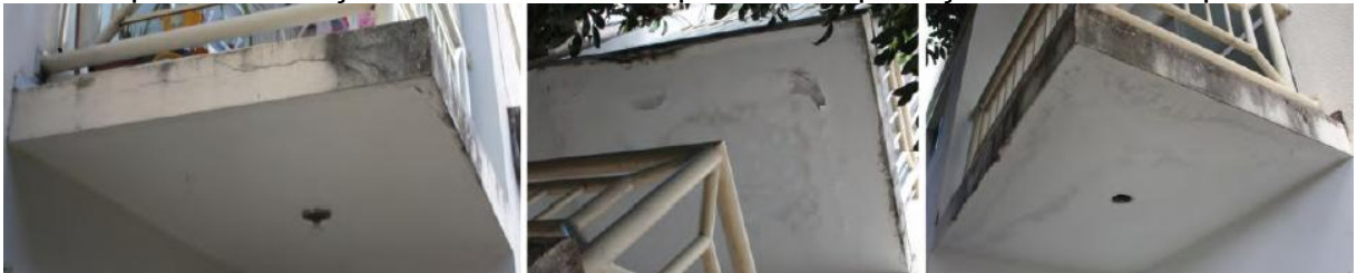
Figura 28– Degradação do revestimento das lajes das sacadas do Bloco A por falha de impermeabilização e ausência de dispositivo de proteção contra intempéries.
