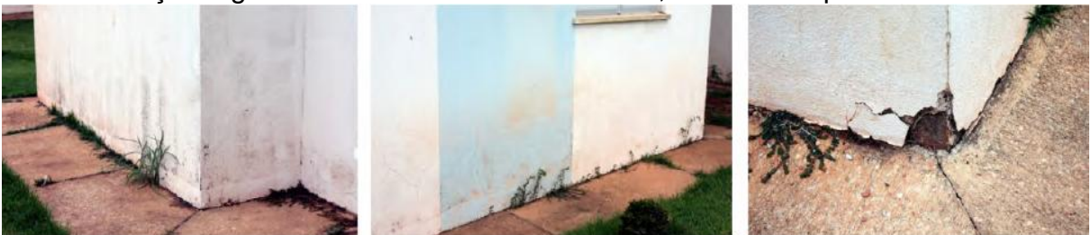
Figura 17 – Sujidades, vesículas, desprendimento de película de pintura e fissuras de dilatação higrotérmica na fachada do bloco 4, no nível do pavimento térreo.
