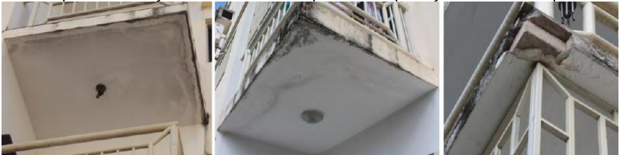
Figura 27– Degradação do revestimento das lajes das sacadas do Bloco A por falha de impermeabilização e ausência de dispositivo de proteção contra intempéries
