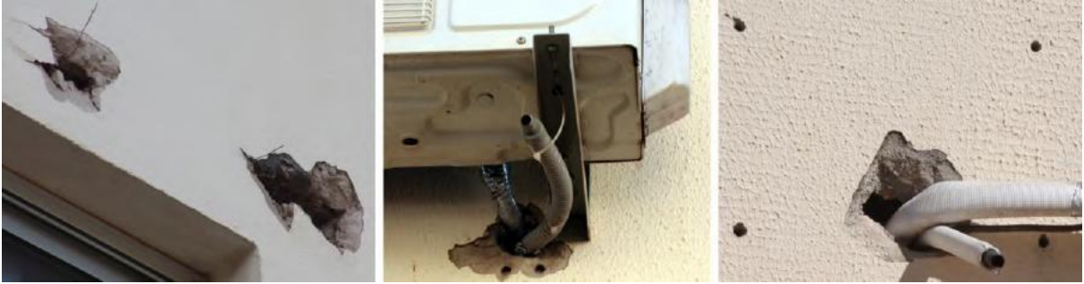
Figura 33– Degradação do revestimento das fachadas para instalação de grades em esquadrias e drenos dos sistemas de condicionamento de a, blocos A, B e F.
