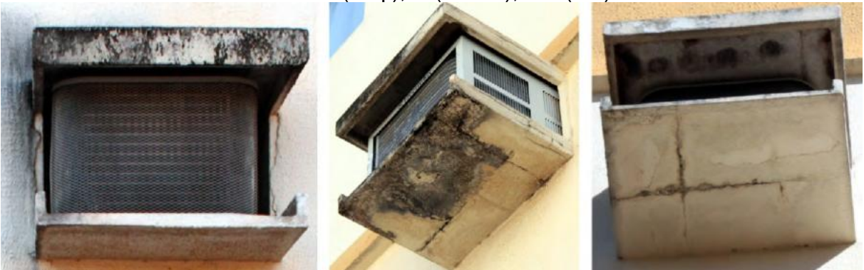
Figura 35– Degradação dos suportes dos condicionadores de ar tipo janela nos blocos D (esq.), E (centro), e F (dir.).
