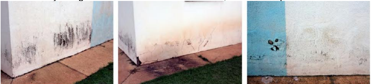
Figura 16 – Sujidades, vesículas, desprendimento de película de pintura e fissuras de dilatação higrotérmica na fachada do bloco 3, no nível do pavimento térreo.
