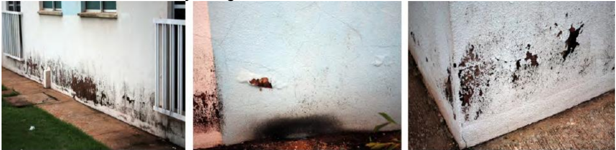
Figura 14– Sujidades, vesículas, desprendimento de película de pintura e fissuras de dilatação higrotérmica na fachada do bloco 1.
