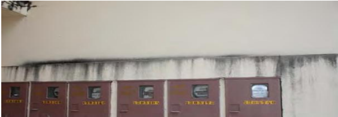
Figura 42– Mofo e sujidades no painel dos quadros de medição de energia elétrica do bloco A.
