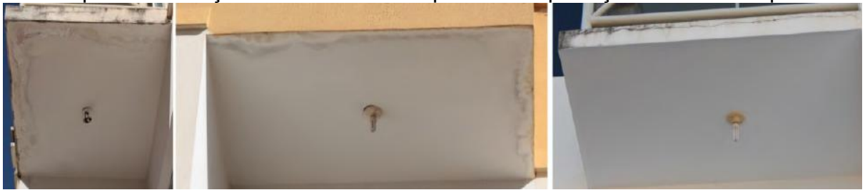
Figura 30– Degradação do revestimento das lajes das sacadas do Bloco A por falha de impermeabilização e ausência de dispositivo de proteção contra intempéries.
