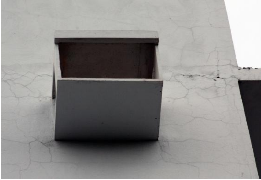
Figura 53– Fissuras de retração do revestimento argamassado no bloco A.
