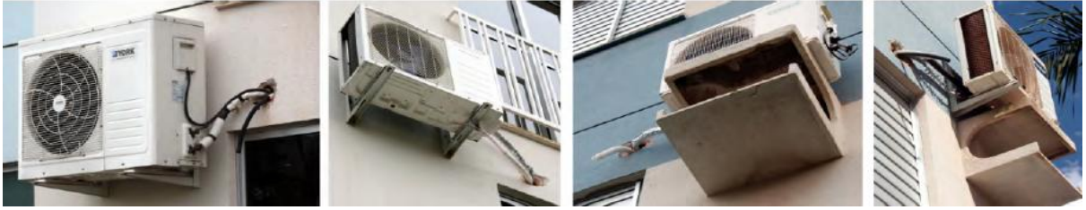
Figura 22– Presença de furos nas fachadas dos blocos 1, 4, 5 e 6, com degradação do revestimento para passagem de drenos dos sistemas de condicionamento de ar.
