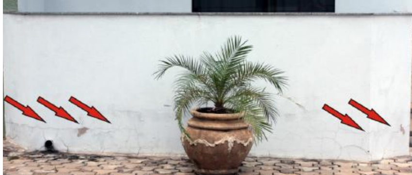
Figura 47– Fissura característica de dilatação térmica em extremidade inferior de sacada bloco B com deslocamento da película de pintura e mofo.
