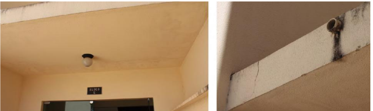
Figura 38– Manchas características de infiltração na laje de cobertura de hall de entrada Bloco E.
