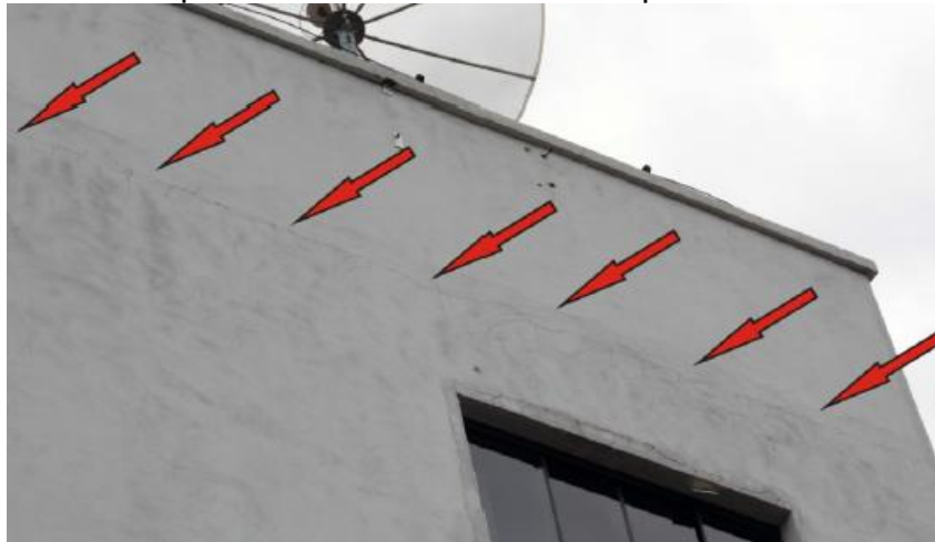
Figura 54– Fissuras características de dilatação térmica entre laje de concreto armado e o painel de alvenaria no ultimo pavimento do bloco.
