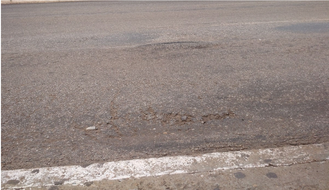
Figura 18 - Manifestação Patológica na parada de ônibus da quadra 103 Sul: Afundamento Local
