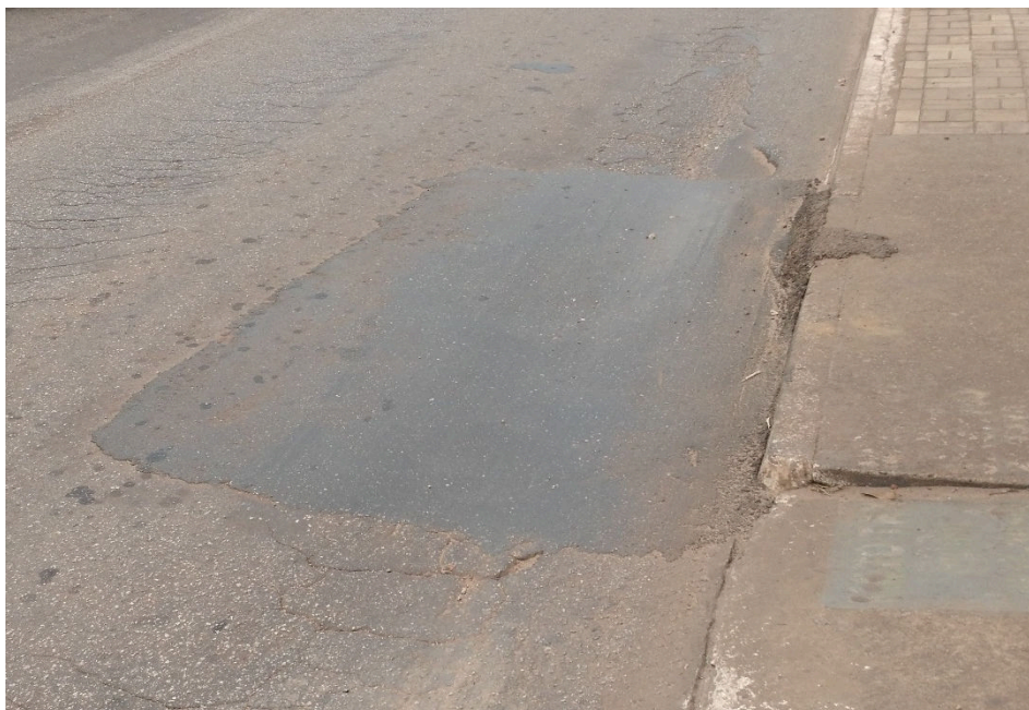
Figura 23 - Imagem do pavimento asfáltico na parada da quadra 101 Norte:
