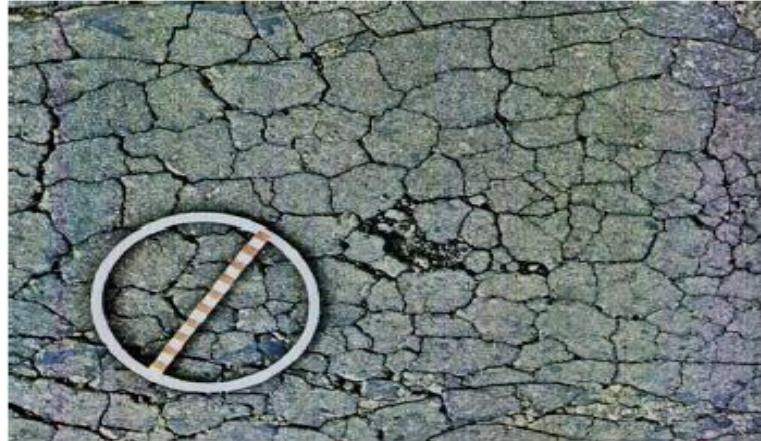
Figura 9: Trinca interligada – tipo jacaré.
