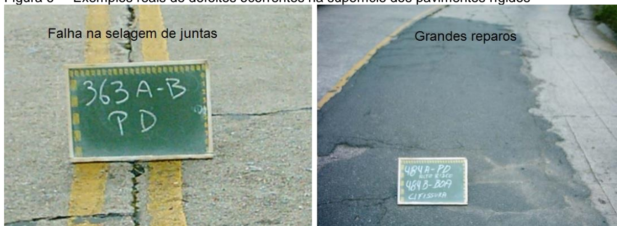
Figura 6 – Exemplos reais de defeitos ocorrentes na superfície dos pavimentos rígidos
