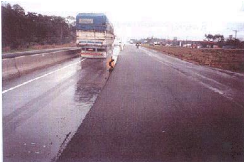
Figura 31 – Escoamento da água pelo acostamento na Estrada do Coco – BA
