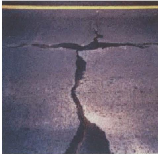
Figura 14 – Fotografia de fendas de onde ocorre a subida de finos.
