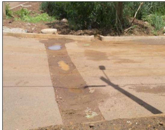
Figura 20 - Valas encharcadas sem pavimentação já com sinais de recalque. Fonte: Do autor (2018)
