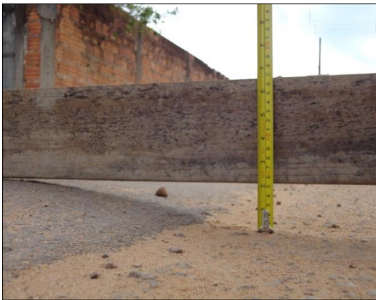
Figura 19 - Recalque em trechos repavimentados. Fonte: Do autor (2018)
