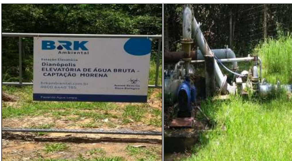
Figura 21 - Estação Elevatória de Dianópolis.
