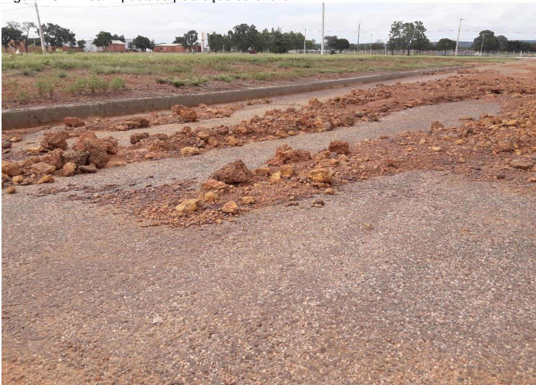
Figura 25 – Área impactada pela ação da chuva
