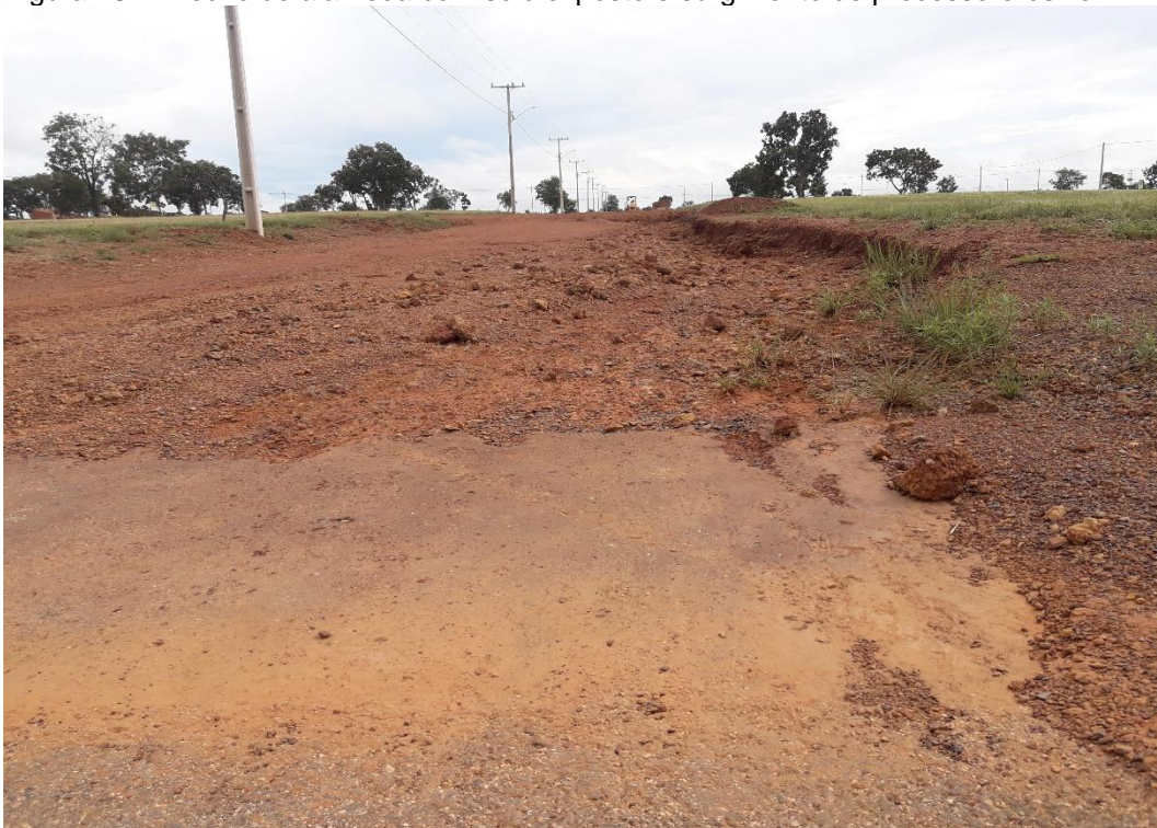
Figura 26 – Trecho de alameda com solo exposto e surgimento de processo erosivo
