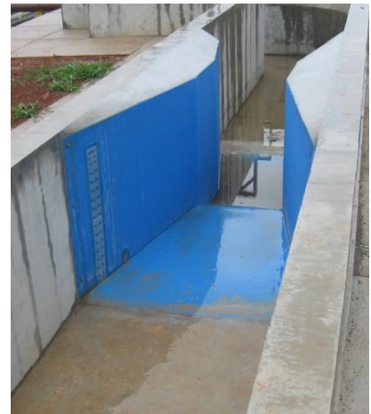
Figura 4 – Calha Parshall instalada.
