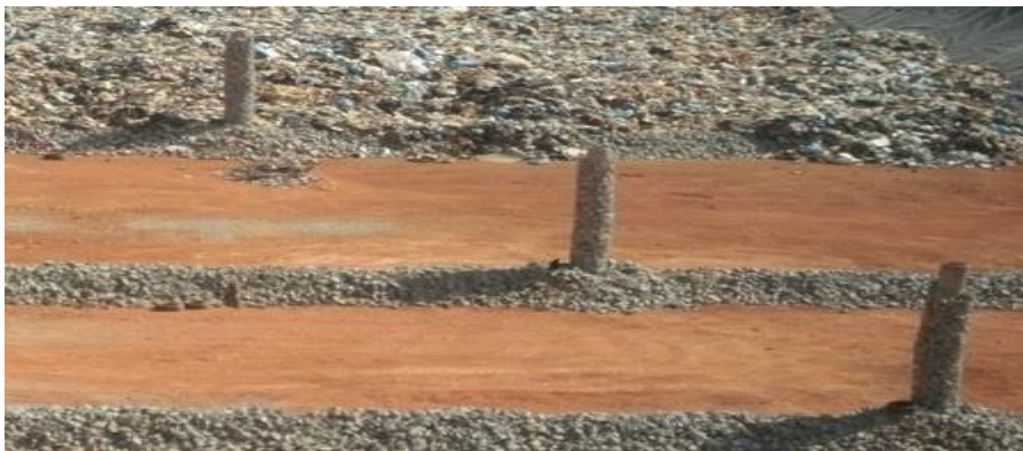
Figura 3 - Dreno para controle de gases. Fonte: Revista Nacional de Gerenciamento de Cidades.
