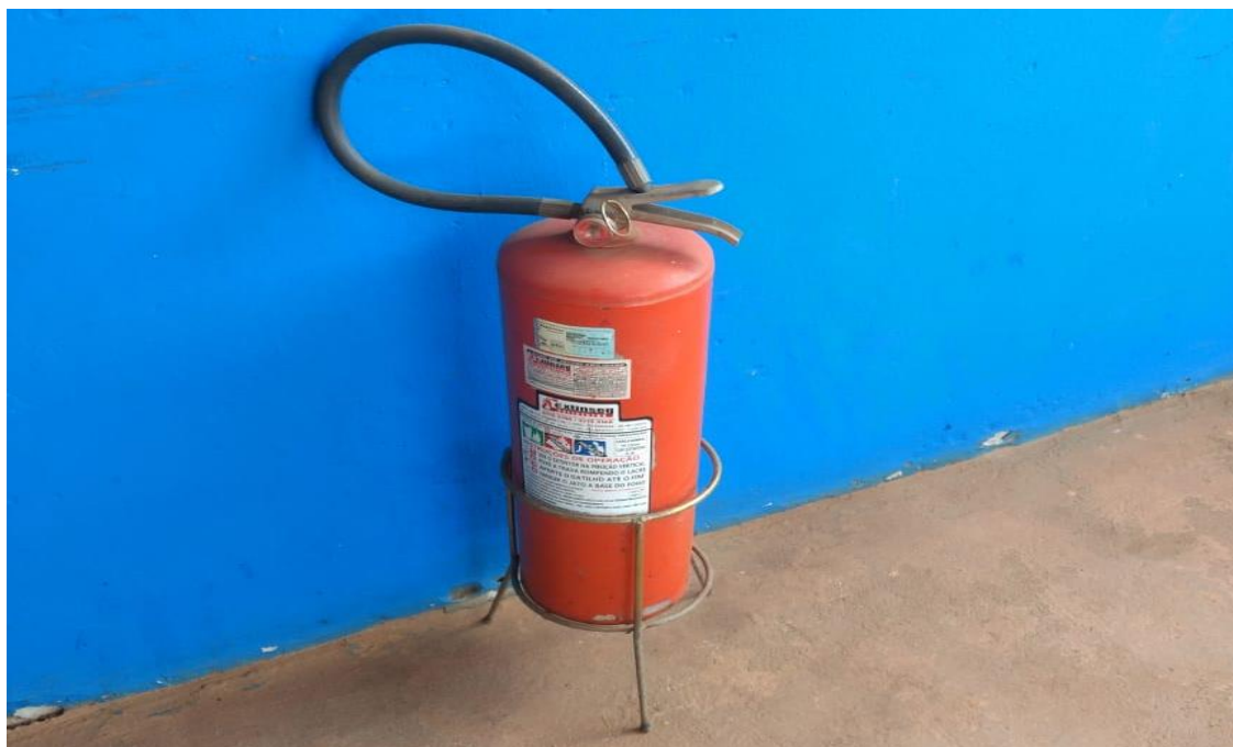
Figura 9 – Equipamento de Combate a Incêndio. Fonte: Autor, 2018.
