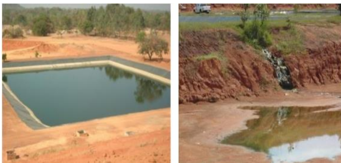
Figura 4 - Sistema de tratamento de chorume. Fonte: Revista Nacional de Gerenciamento de Cidades.
