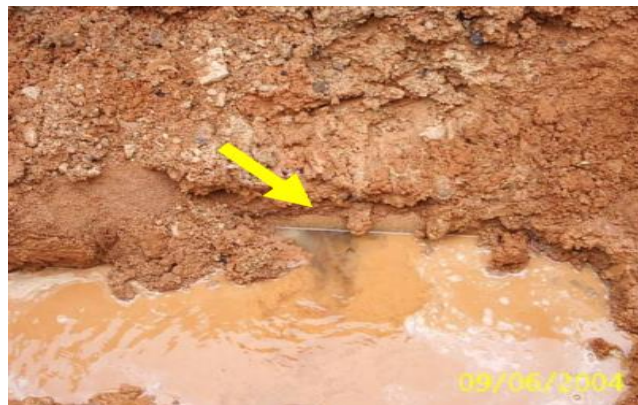
Figura 6: Vazamentos que não afloravam
