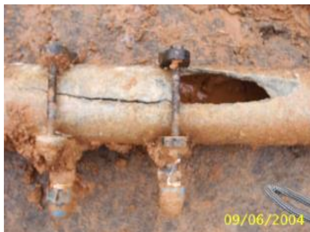
Figura 7: Rompimento da Rede
