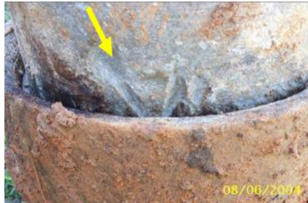
Figura 5: Problemas nos Anéis de Juntas
