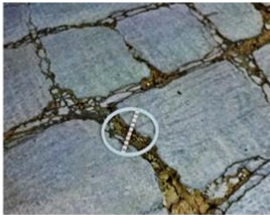
Figura 13 - Trinca tipo “Bloco”
