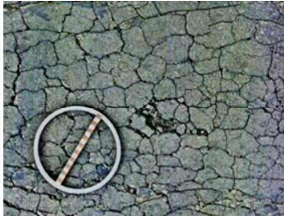
Figura 12 - Trinca tipo “Couro de Jacaré”
