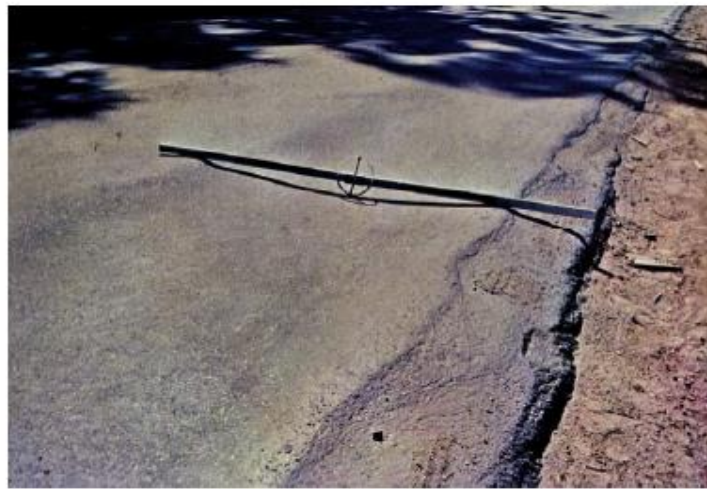
Figura 14 - Afundamento de consolidação
