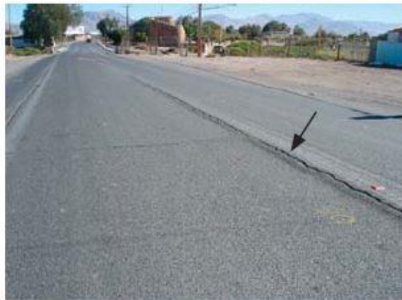
Figura 14 - Trinca de retração
