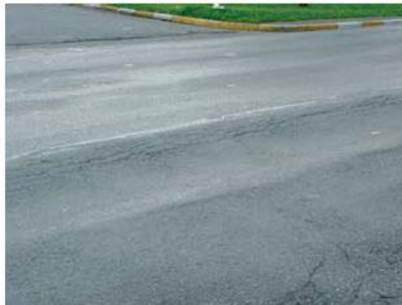
Figura 17 - Afundamento plástico nas trilhas de roda
