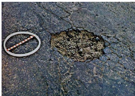
Figura 24 - Panela ou buraco
