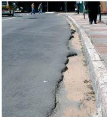
Figura 21 - Escorregamento do revestimento
