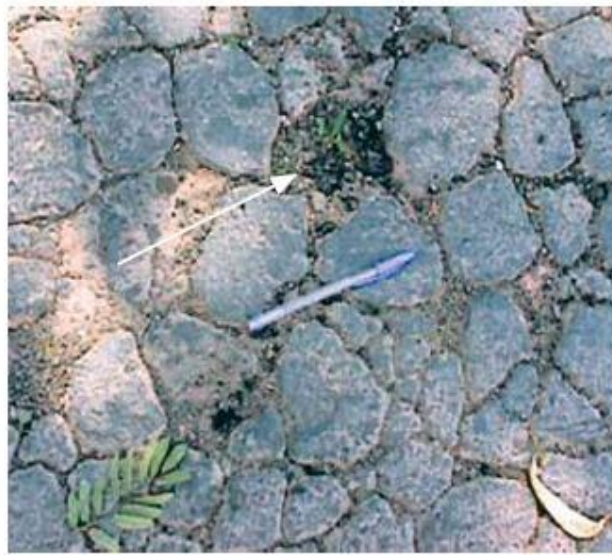
Figura 15 - Trinca tipo "couro de jacaré"
