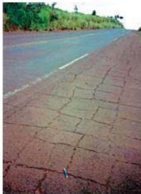
Figura 16 - Trinca tipo bloco sem erosão
