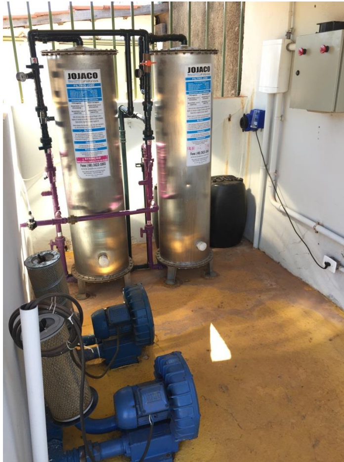
Figura 30 – Casa de bomba com dosador de cloro.
