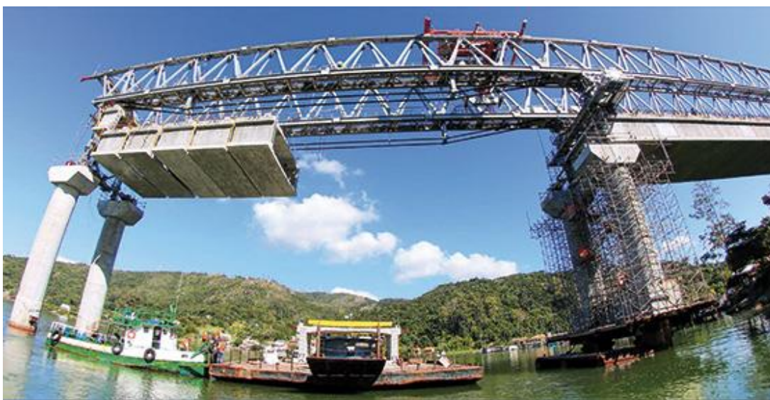
Figura 29: Içamento das aduelas por meio de treliça lançadeira superior por avanços progressivos
