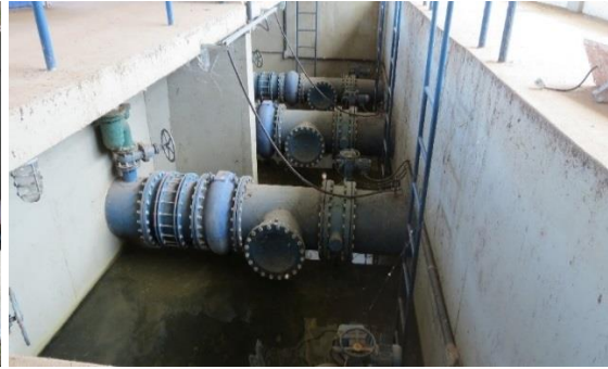
Figura 34- Tubulação de recalque Ø 850mm
