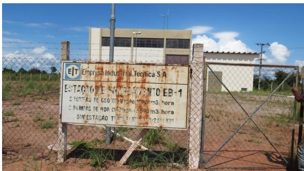
Figura 22- Estação de bombeamento São João
