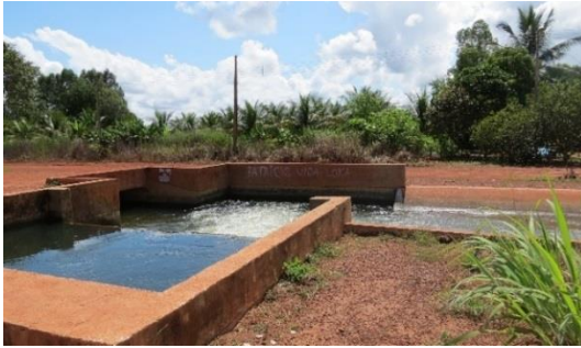
Figura 28- Caixa de distribuição
