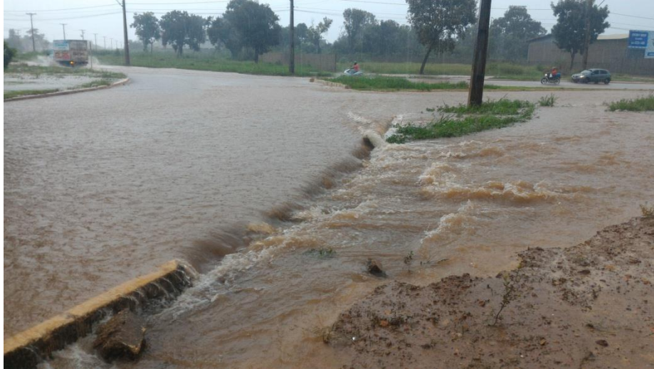
Figura 23: Ação da enxurrada na via, danificando o meio fio na rotatória.
