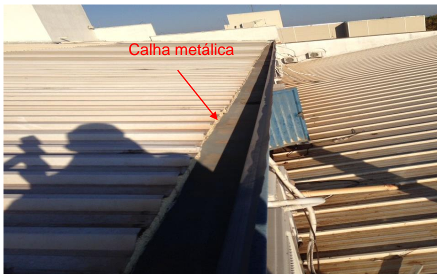
Figura 21 - Identificação de Sistema de Captação Pluvial – Calha Metálica
