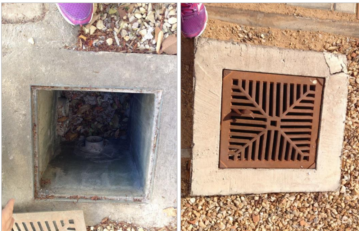
Figura 23 - Identificação de Sistema de Captação Pluvial - Caixa de Passagem Coletora Pluvial
