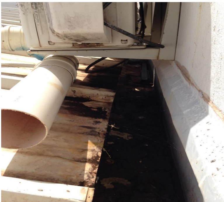
Figura 19 - Vista de calhas instaladas
