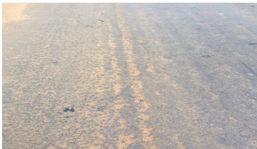
FIGURA 22 - Afundamento por consolidação na trilha de roda.
