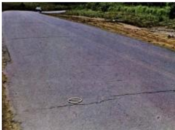
FIGURA 10 - Trinca Isolada -Transversal
