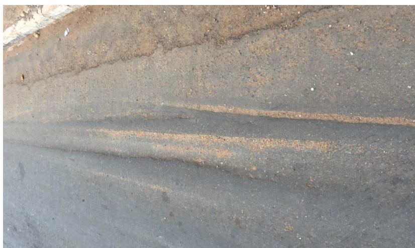
FIGURA 21 - Afundamento plástico na trilha de roda, e escorregamento.
