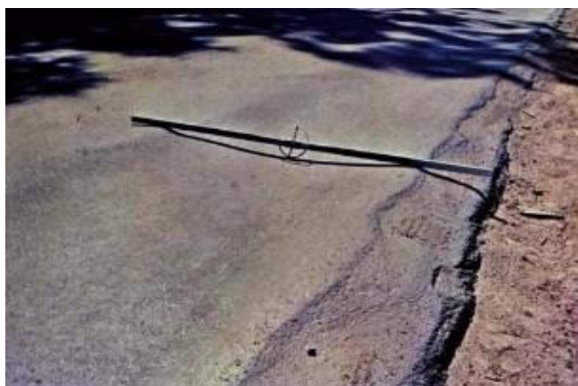
FIGURA 6 - Afundamento de trilha de roda
