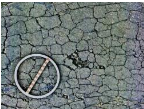
FIGURA 11 - Trinca Interligada - Tipo Couro Jacaré
