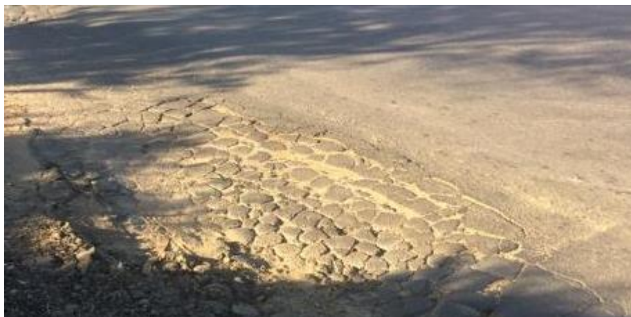
FIGURA 18 – Manifestação patológica, trincas couro de jacaré com erosão.
