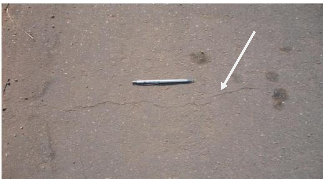
FIGURA 16 – Trinca transversal curta.
