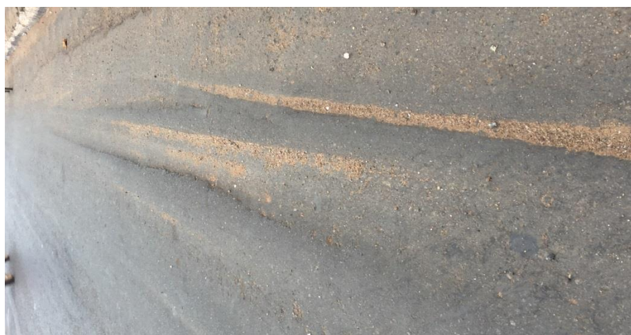
FIGURA 28 – Escorregamento do revestimento betuminoso.
