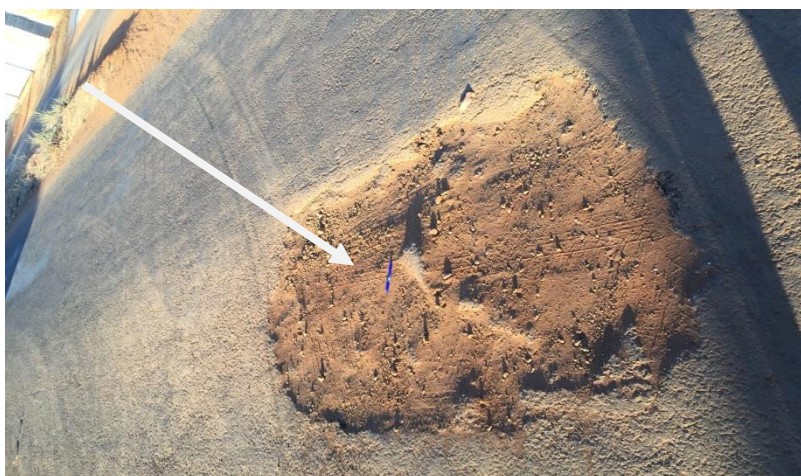
FIGURA 20 - Afundamento por consol. Localizado e buraco/panela.
