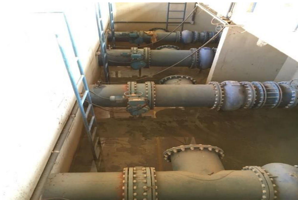
Figura 14 - Tubulações de Recalque de 500mm e 700 mm
