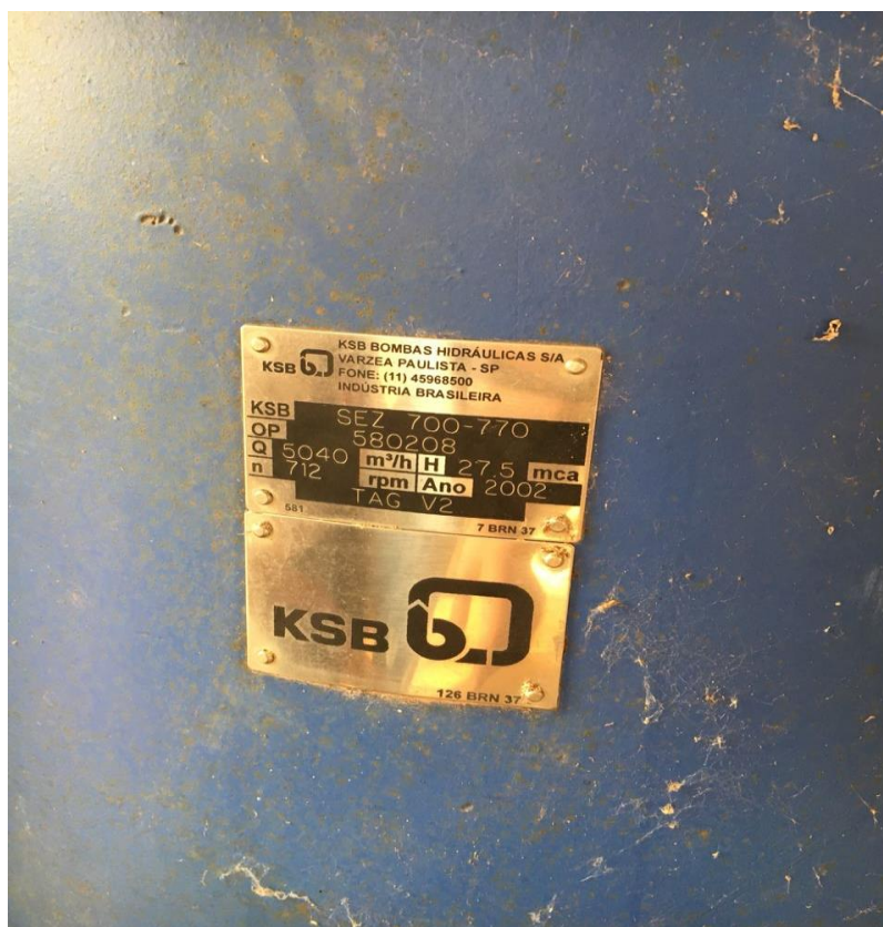
Figura 19 - Dados da bomba KSB de 750 cv
