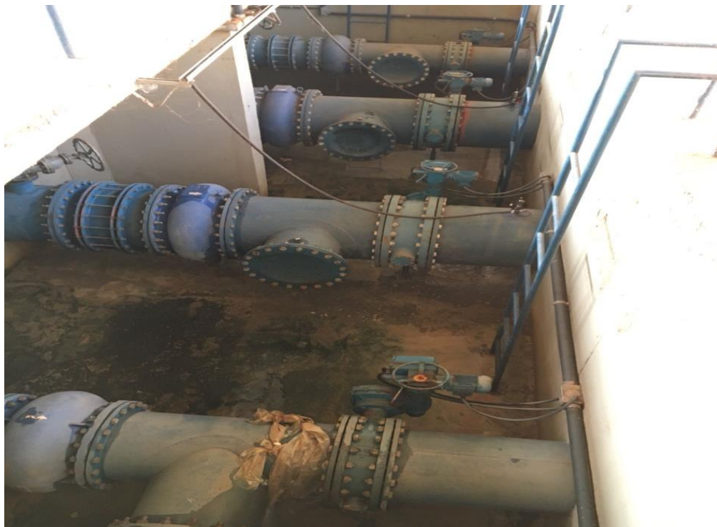
Figura 16 - Vazamentos na Válvula de retenção, registro de gaveta e juntas de vedação
