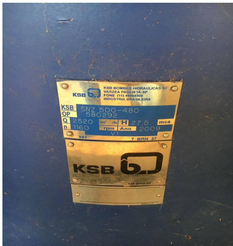
Figura 17 - Dados da bomba KSB de 400 cv
