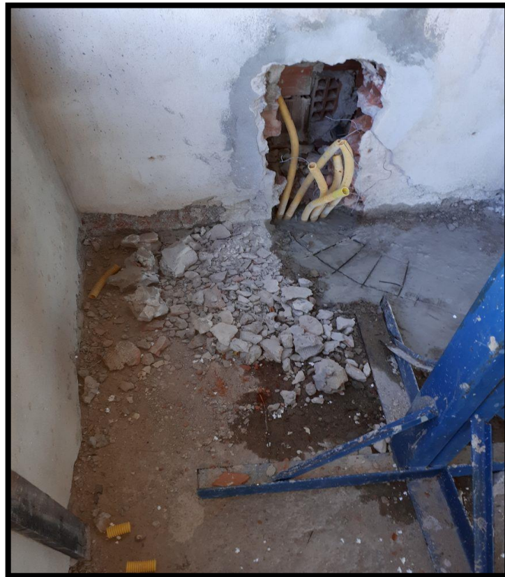
Figura 10 - Produção de resíduos sólidos de demolição por ocorrência de adaptação de projeto inicial.
