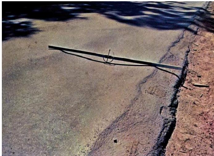
Figura 8 - Afundamento da trilha de roda.
