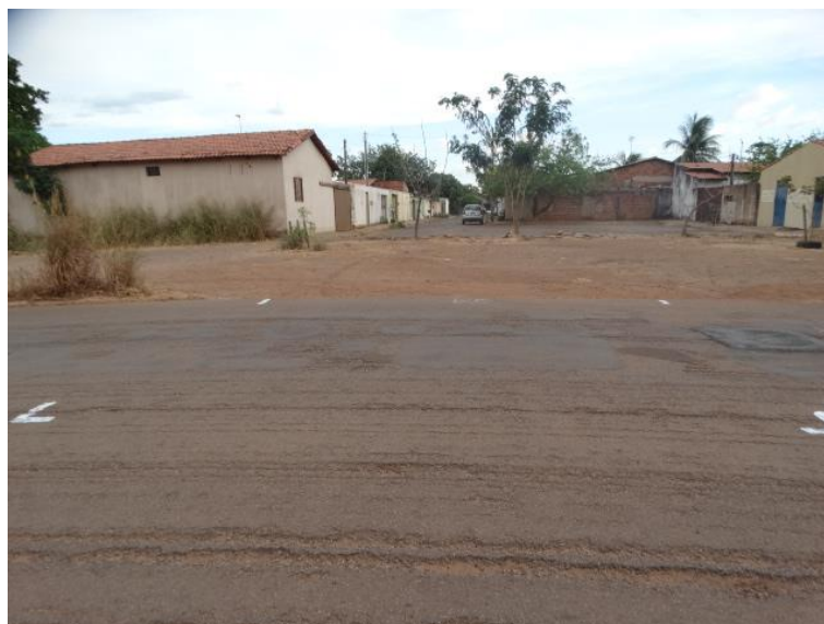
Figura 20 – Estação 35 apresenta defeitos no revestimento asfáltico dos tipos: panela, remendo e desgaste, além disso há ausência de meio fio.
