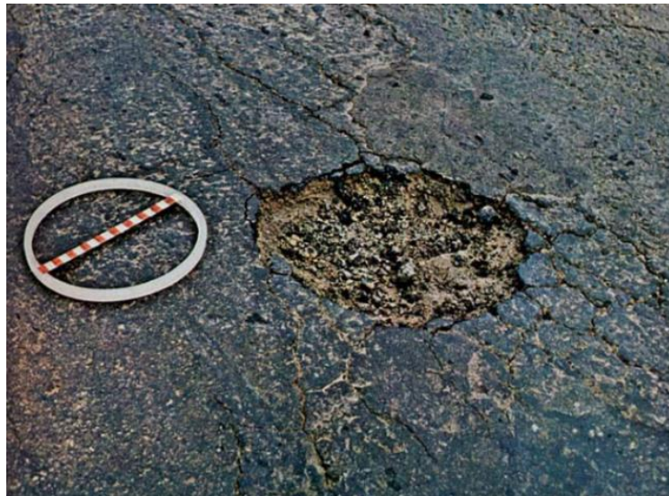
Figura 13 - Panela ou buraco
