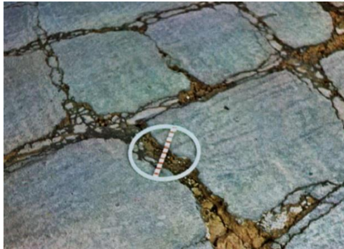
Figura 6 - Trinca tipo bloco
