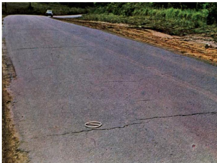
Figura 3 - Trinca isolada transversal
