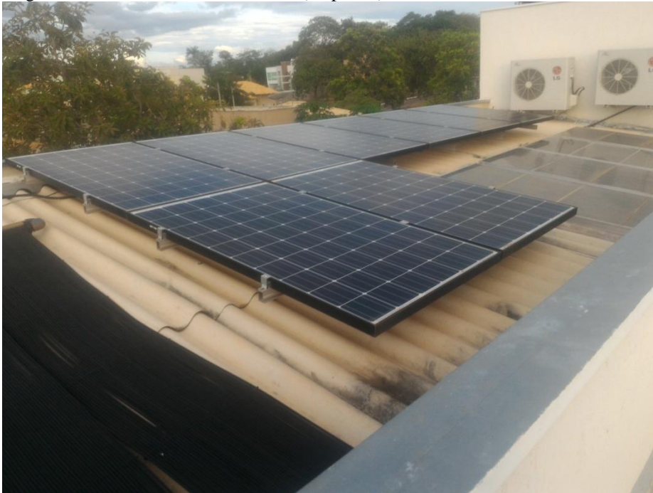
Figura 12 Sistema fotovoltaico casa 1 (12 placas).
