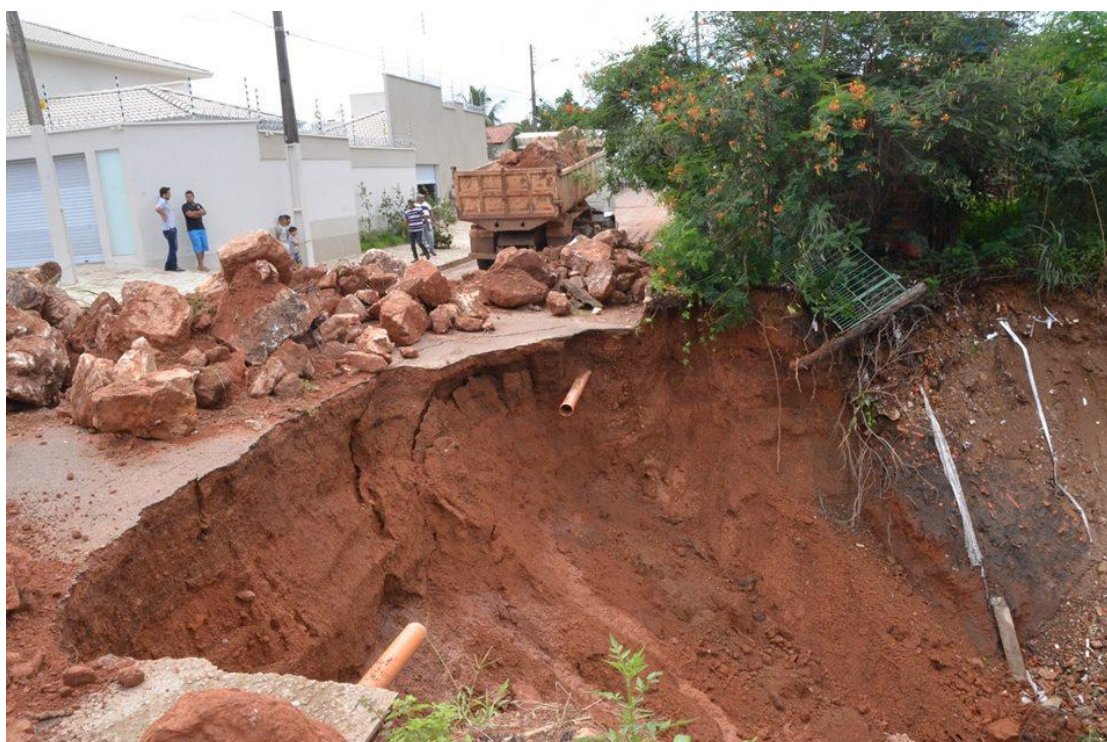
Figura 11. Voçoroca existente em Paraíso do Tocantins
