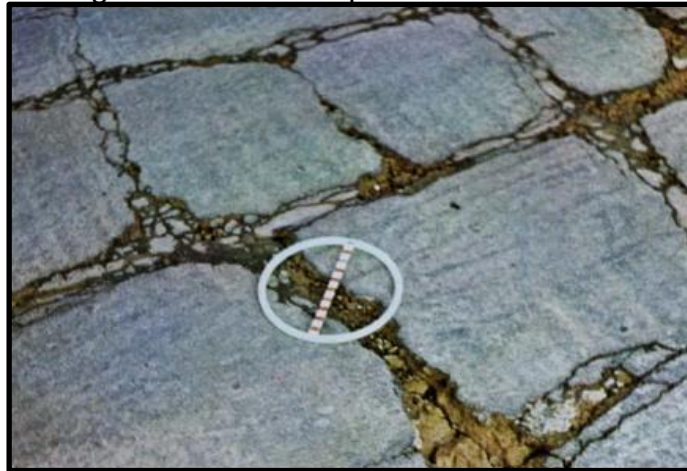
Figura 10 – Trinca tipo bloco sem erosão
