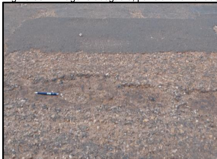
Figura 38 – Imagens desgaste, panela e remendos
