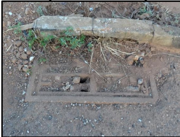
Figura 46 – Imagem de sistema de drenagem obstruída
