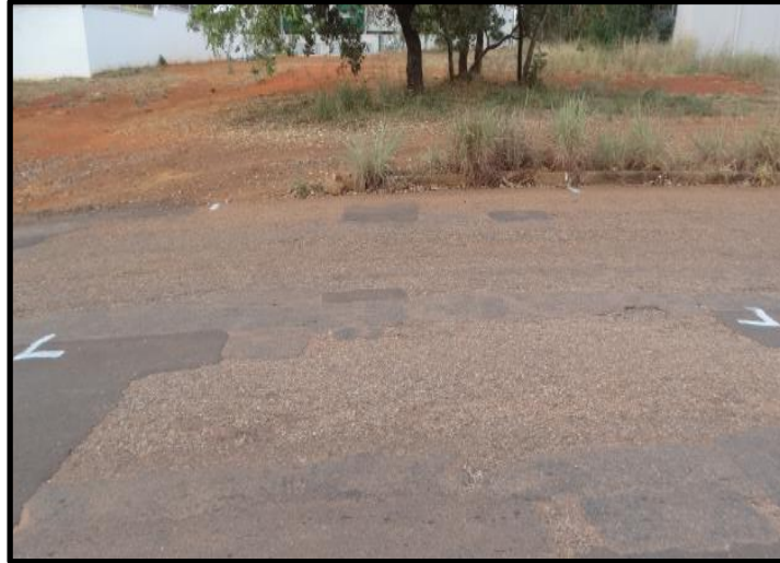
Figura 37– Imagens de estação com desgaste, panelas e remendos
