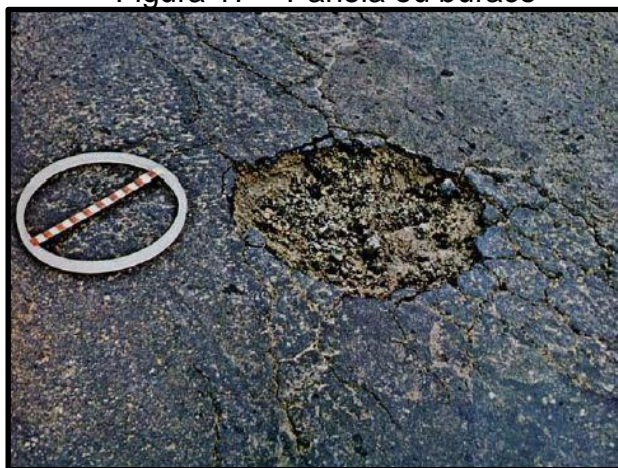
Figura 17 – Panela ou buraco
