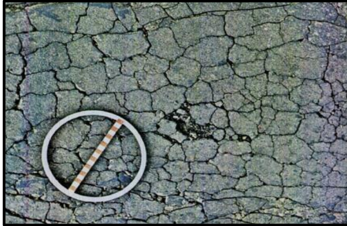
Figura 9 – Trinca tipo “couro de jacaré”
