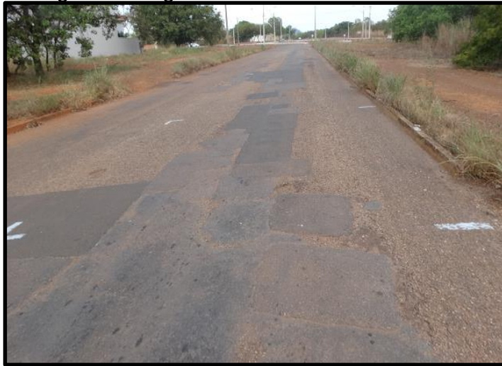
Figura 32- Imagem de seguimento da avenida com muitos remendos
