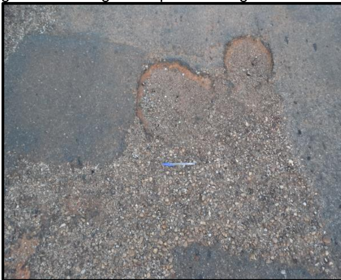
Figura 44 – Imagem de panela desgaste e remendo
