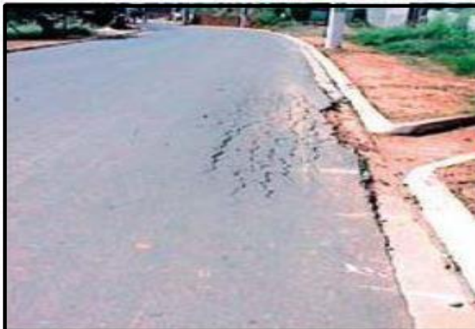
Figura 12- Afundamento por consolidação localizado
