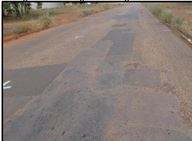
Figura 40 – Imagens de segmento crítico
