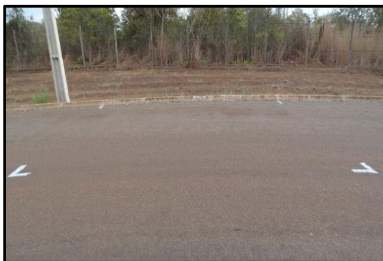
Figura 36 – Imagens de estação sem defeitos
