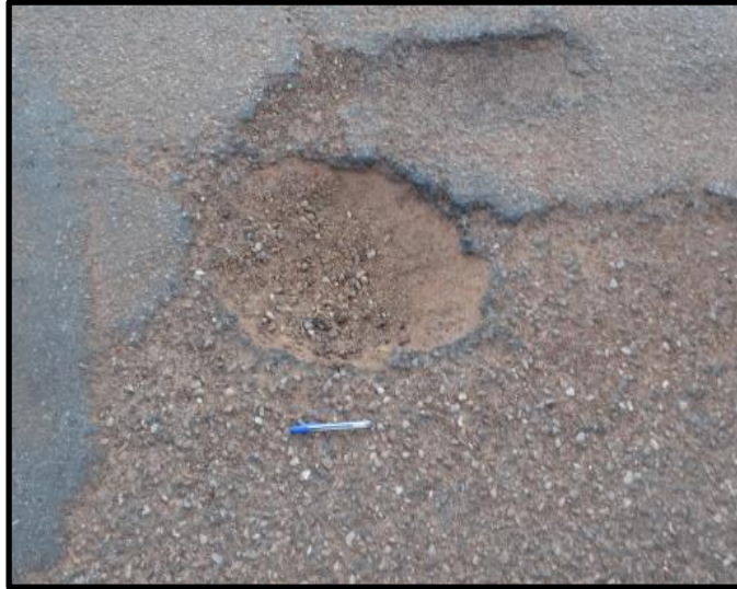
Figura 43 – Imagem de panela desgaste e remendo
