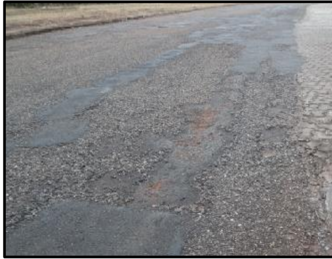
Figura 47 – Imagem de trecho crítico com grande quantidade de desgaste, panelas e remendos
