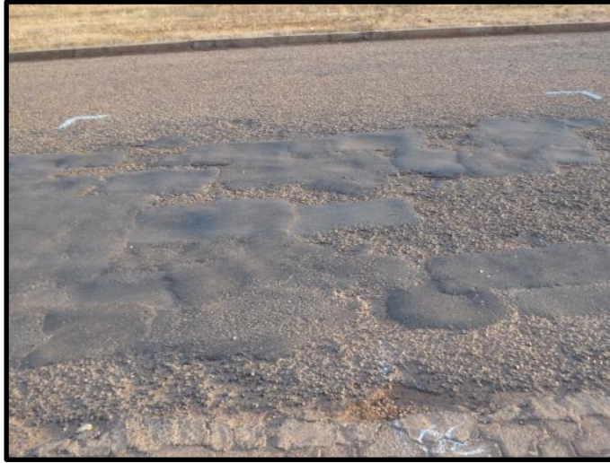
Figura 41 – Imagem de estação com grande quantidade de remendos
