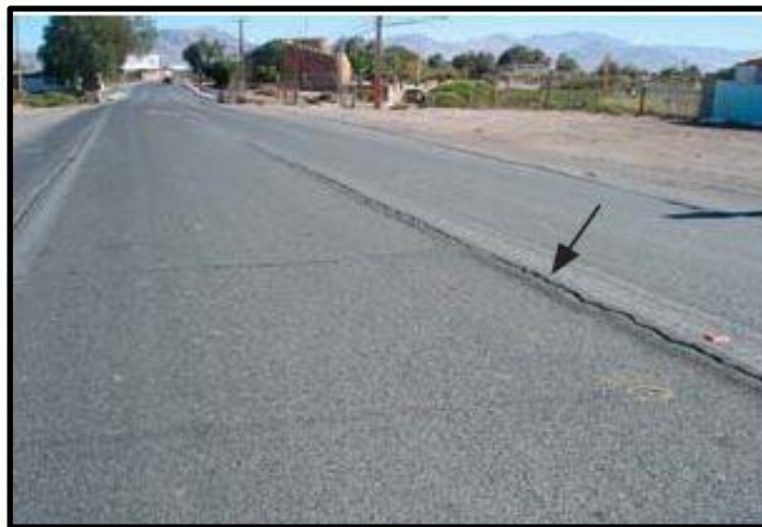
Figura 8 – Trinca de retração
