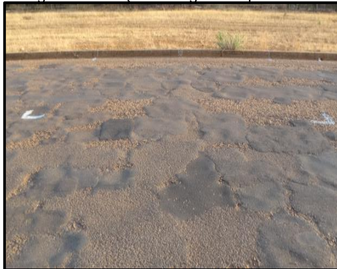
Figura 42 – Imagem de estação com grande quantidade de remendos
