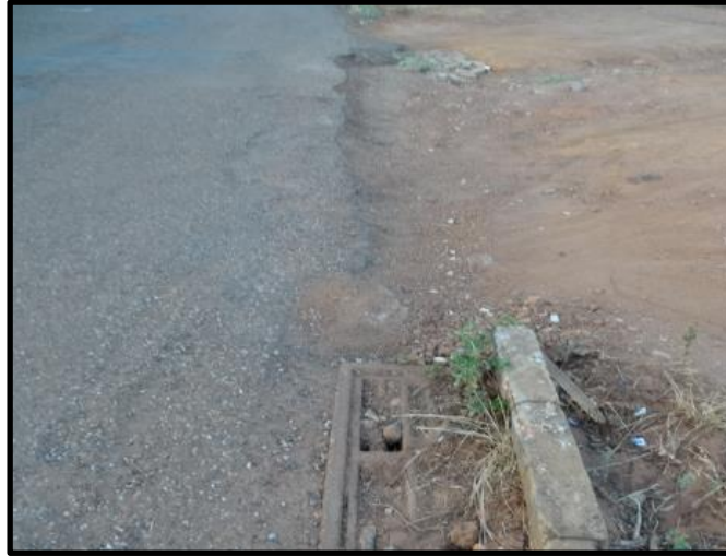
Figura 45 – Imagem erosão por falta de meio fio
