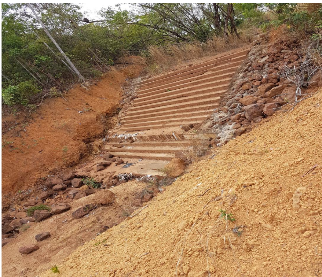
Figura 11 – Localização da escada hidráulica no parque Cesamar.
