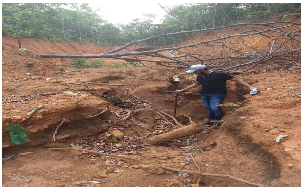
Figura 6 – Formação de uma Ravina dentro da voçoroca.
