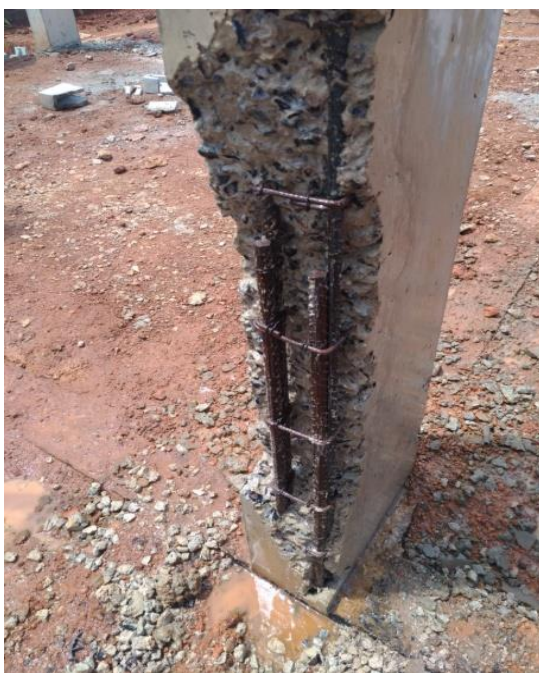
Figura 12 – Falha de concretagem do pilar 6
