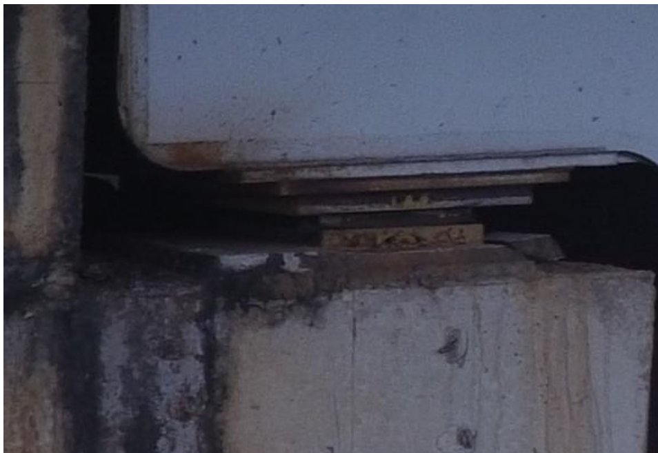
Figura 37- Trinca na base do aparelho
