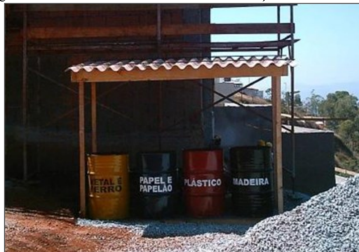
Figura 9 - Armazenamento de resíduos de construção civil em tambores
