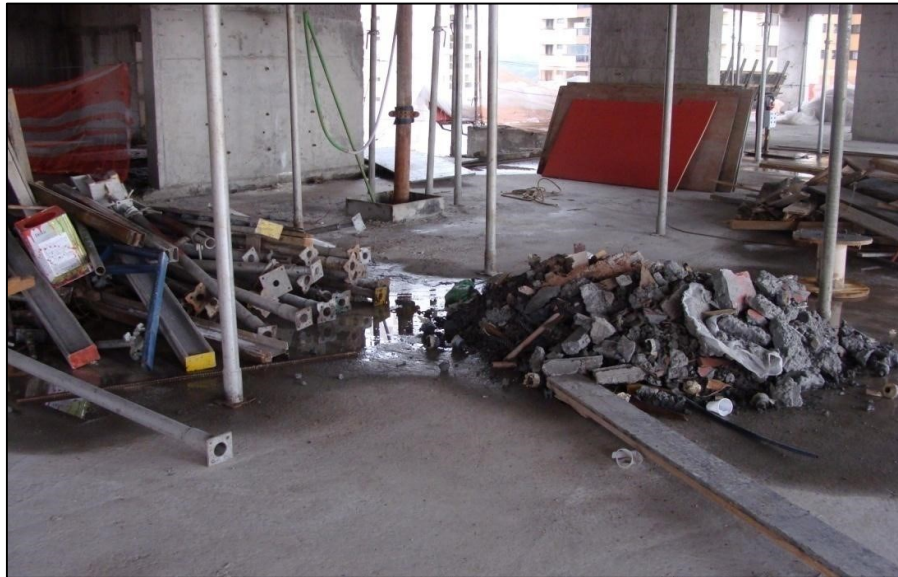
Figura 22 - Materiais e resíduos espalhados em pavimentos
