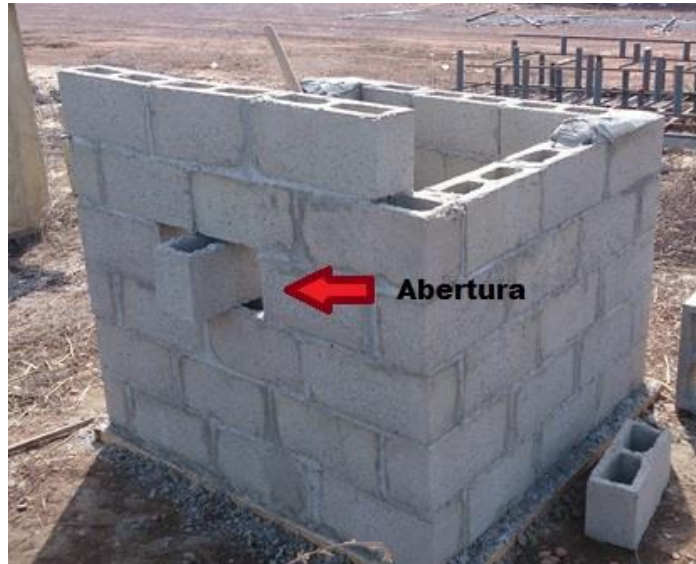
Figura 45: Abertura na fachada oeste.
