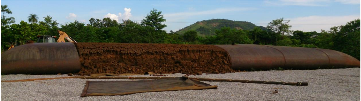
Figura 15: Lodo da ETA 006 condicionado no bag.
